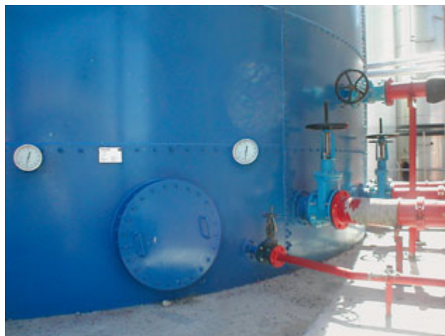
Figura 29: Bocas o nozzles de un Tanque Atmosférico Fuente: (Tankeros, 2014)
