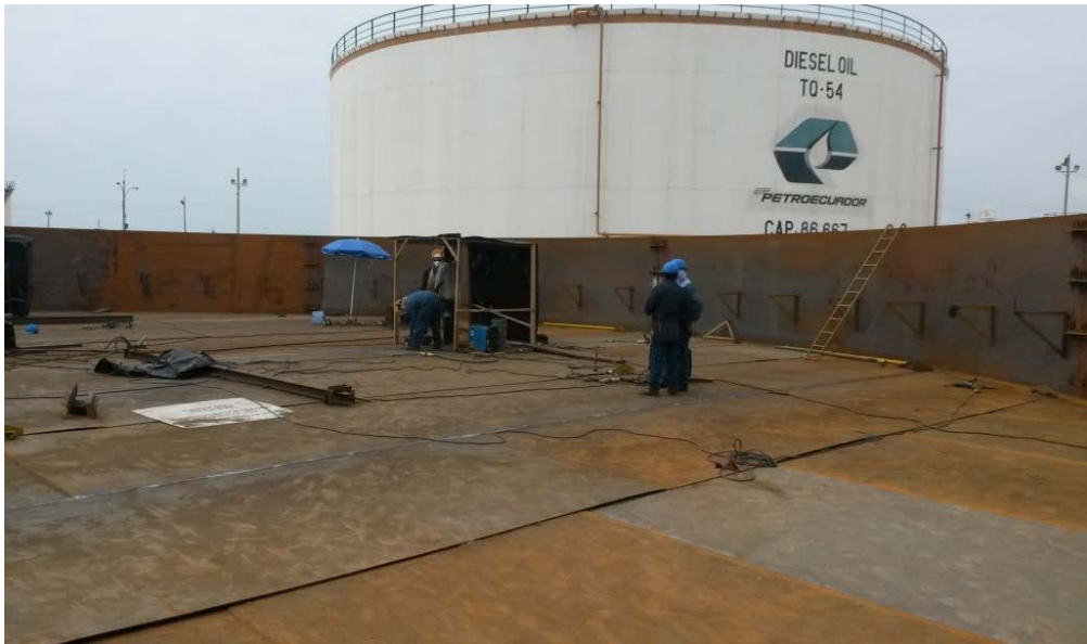
Figura 26: Fondo de un Tanque Atmosférico
