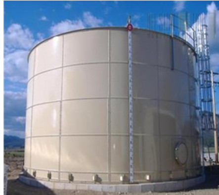
Figura 36: Tanque Empernado Fuente: (Geo-Systems USA, 2014)
