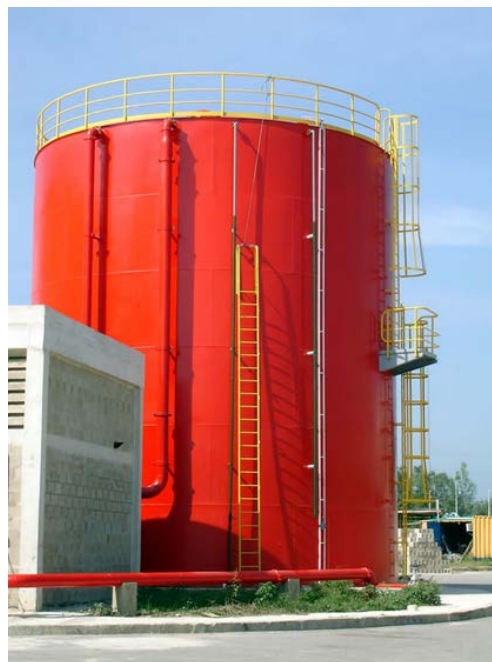
Figura 6: Tanque de almacenamiento de agua SCI Fuente: (Industria Agromecánica del Cauca, 2012)
