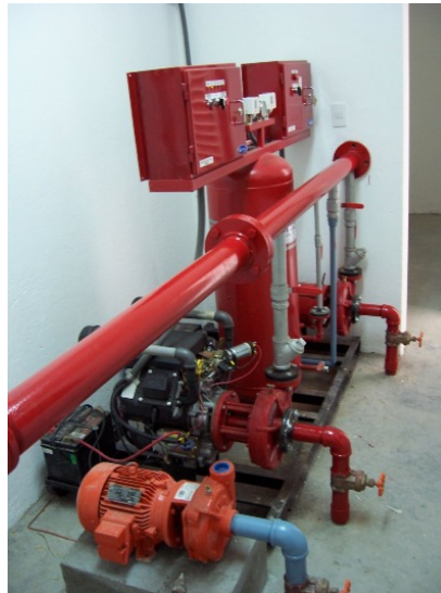
Figura 7: Sistema de bombeo de agua SCI Fuente: (Allbiz, 2013)
