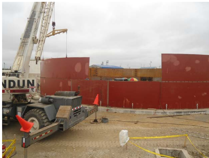
Figura 27: Planchas de cuerpo de un Tanque Atmosférico
