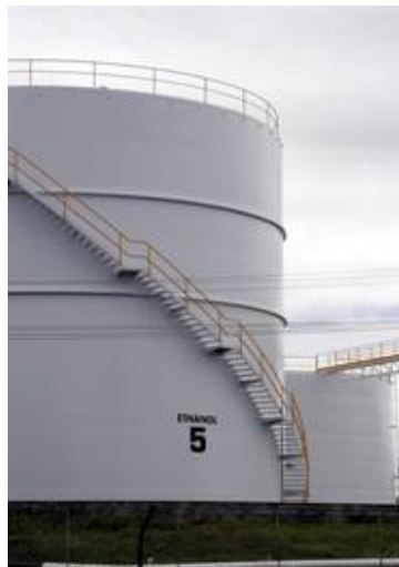
Figura 35: Escalera espiral de un Tanque Atmosférico Fuente:(AGI, 2012)
