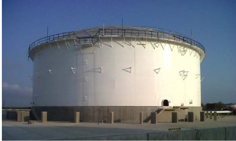
Figura 22: Tanque de techo autoportado Fuente: (CEAzul, 2013)
