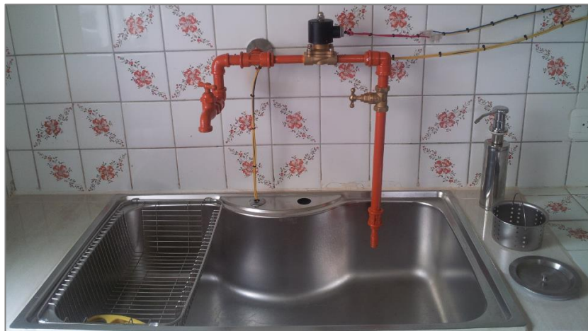
Figura 107. Tanque de lavado y accesorios
