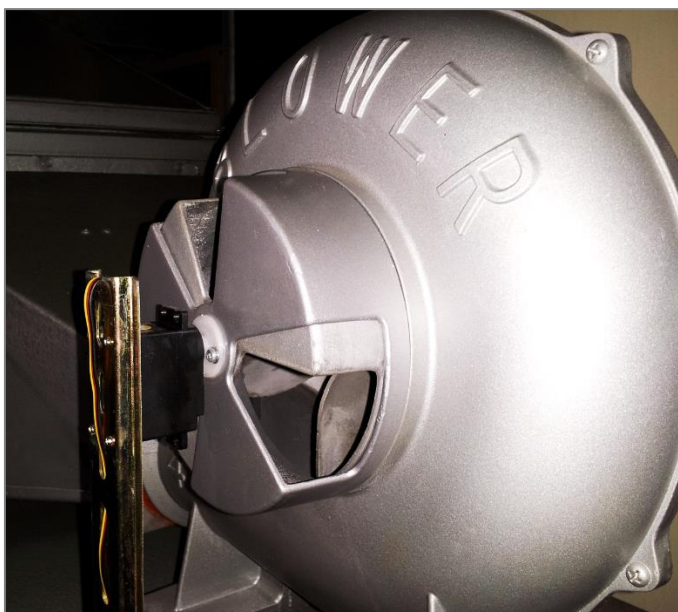
Figura 113. Implementación de servomotor en compuerta de venterol
