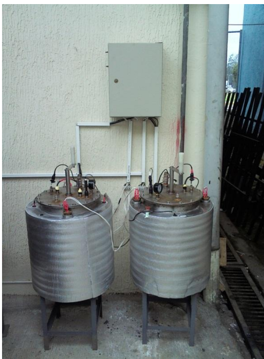
Figura 5.107 Digestores de Microplanta generadora de Biogás
