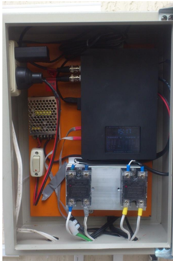
Figura 5.74 Caja de protección eléctrica
