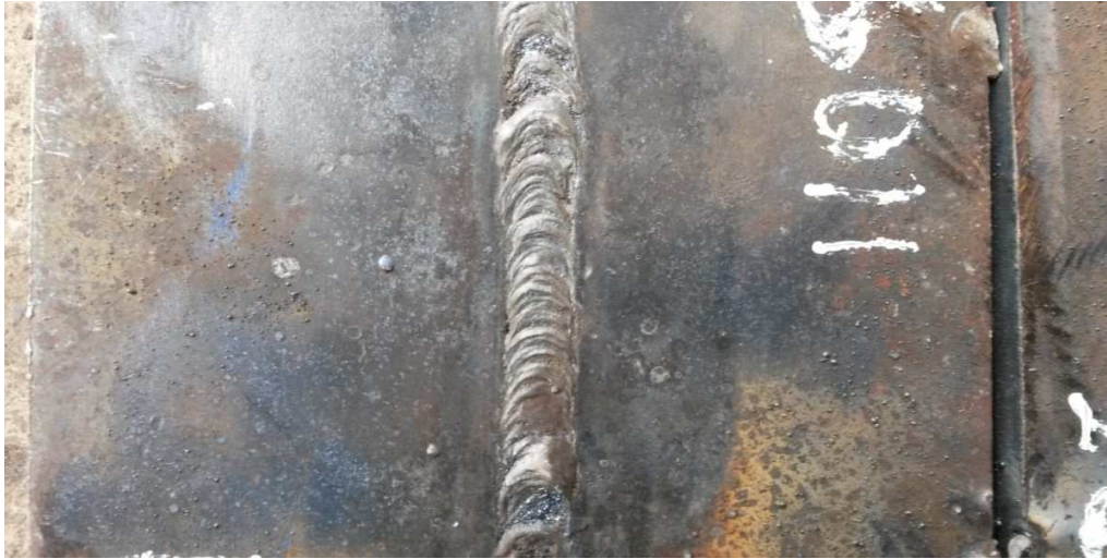
Figura 26. Defectos de Soldadura
