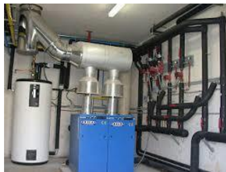
Figura 16 Sistema de climatización
