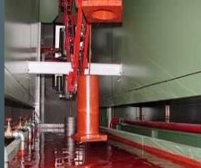
Vista del sistema de pintura por inmersión
