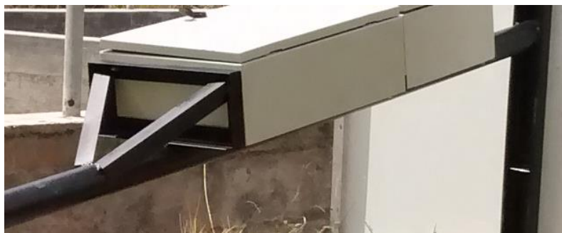
Figura 53 Soporte para colocación de cajas de control, potencia y monitoreo.
