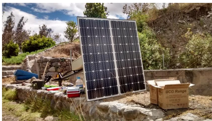
Figura 55 Sujeción de paneles fotovoltaicos.
