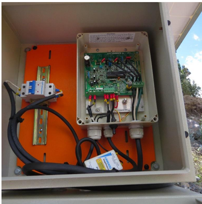
Figura 46 Instalación del sistema de control.
