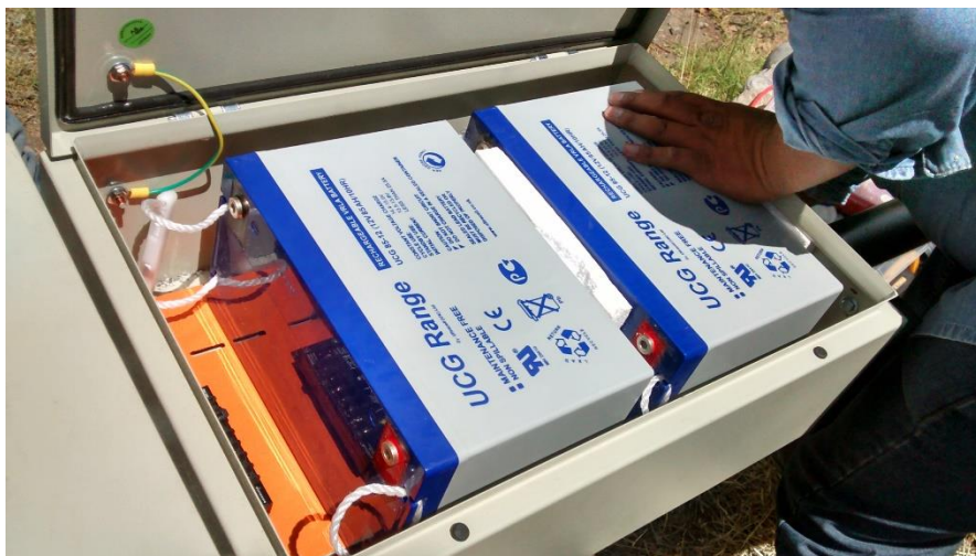
Figura 43 Ubicación del sistema de potencia.
