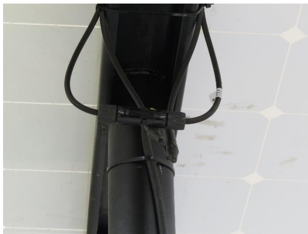
Figura 56 Conexión en serie de paneles fotovoltaicos.
