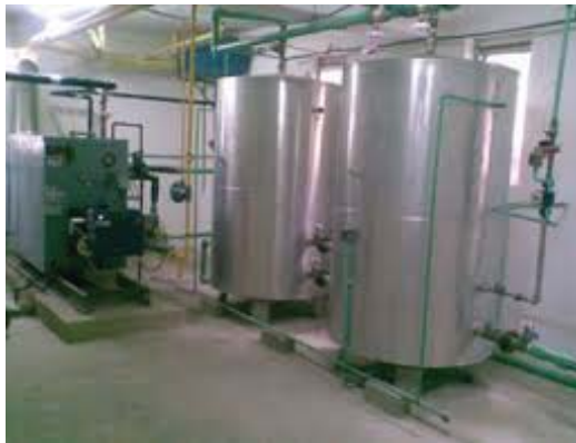
Figura 10 Calderos para calentamiento de piscinas
