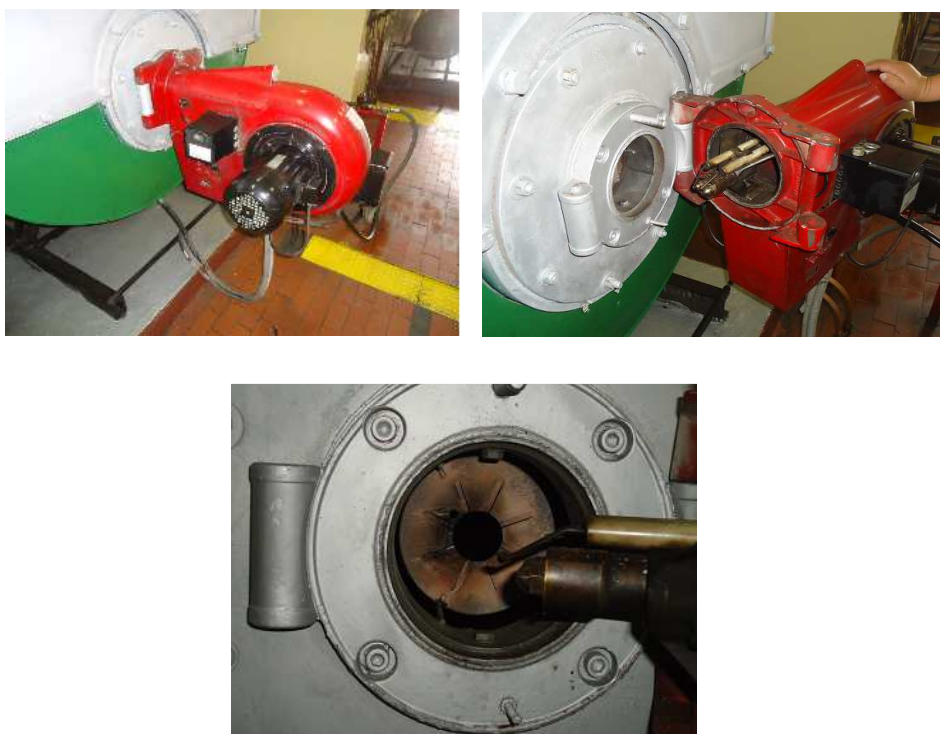
Figura 28 Quemador de encendido
