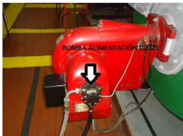
Figura 33 Bomba de alimentación de diésel
