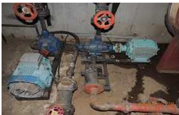
Figura 32 Bombas de alimentación a la caldera
