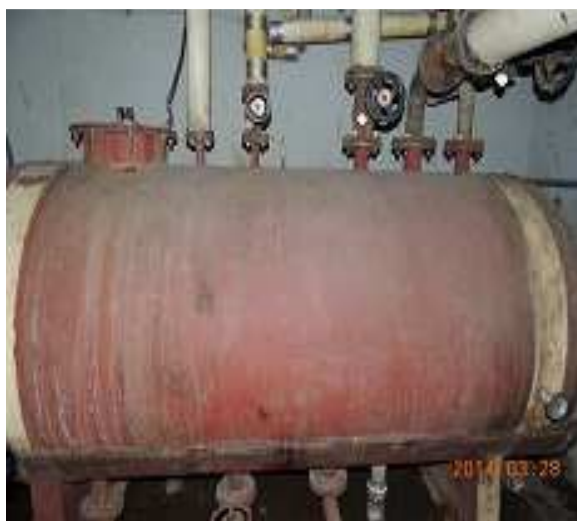
Figura 30 Tanque de condensado-alimentación de agua
