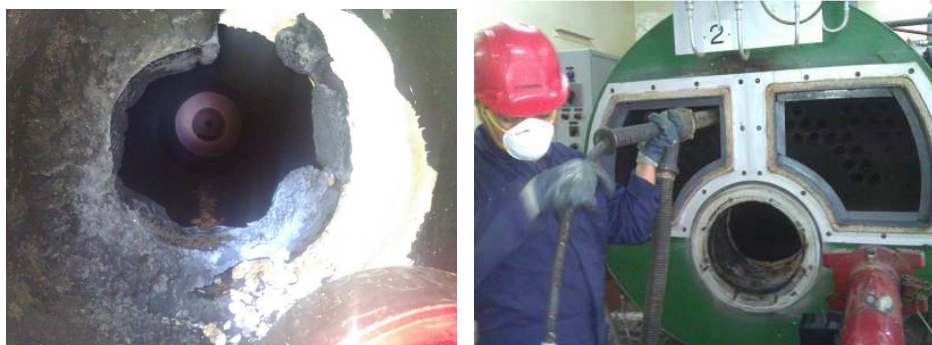
Figura 58 Mala combustión en quemador, mantenimiento y calibración de combustión
