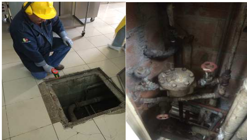
Figura 55 Tubería sin aislamiento
