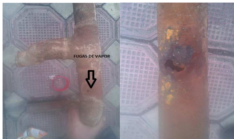
Figura 56 Fugas de vapor en tubería.
