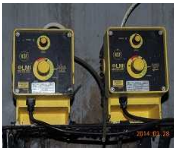
Figura 31 Bombas de alimentación de químicos a la caldera
