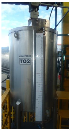
Figura 19 Tanque de Reductores TQ1, Reactor MQ5
