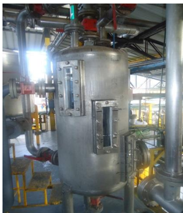
Figura 10 Tanque Separador, Reactor MQ6
