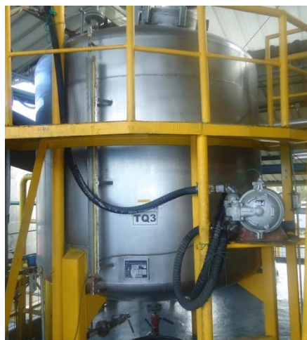
Figura 16 Tanque de Monómeros TQ3, Reactor MQ5
