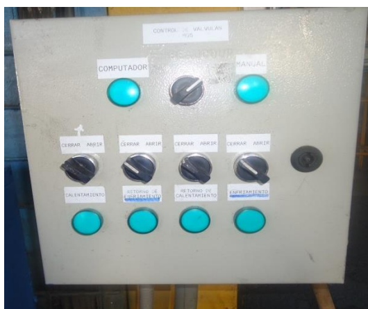
Figura 24 Tablero de control de Válvulas, Reactor MQ5
