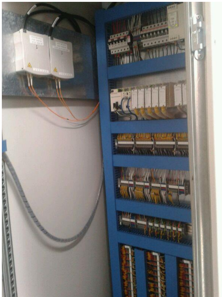
Figura 47 Tablero de control del reactor MQ5
