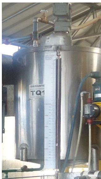
Figura 18 Tanque de Oxidantes TQ1, Reactor MQ5
