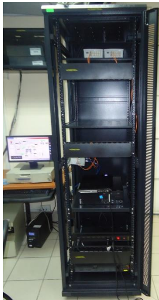
Figura 50 Rack de comunicaciones concluido
