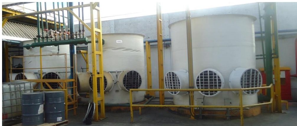
Figura 14 Torres de enfriamiento
