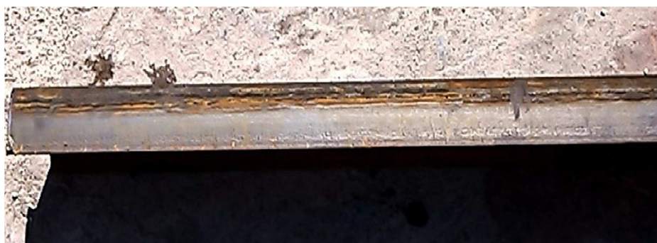
Figura 35. Oxido presente en las vigas debido al almacenamiento
