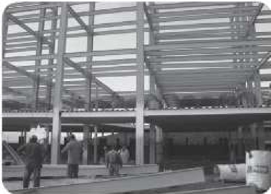
Figura 13. Vigas de un edificio alto para departamentos. Fuente: Álvarez & Chazaro, 2012
