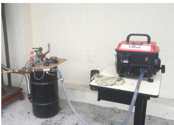
Figura 29. Ingreso del aire y gas de síntesis al motor generador
