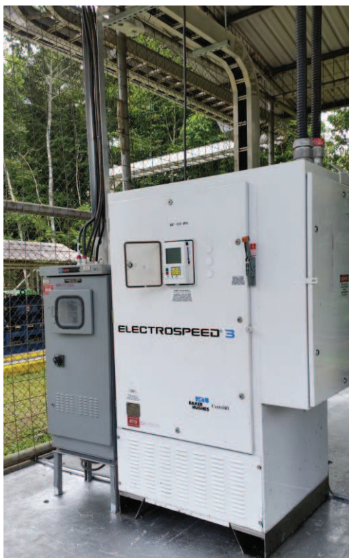
Figura 30: Variador en sitio del Motor Eléctrico de la bomba (MEP).
