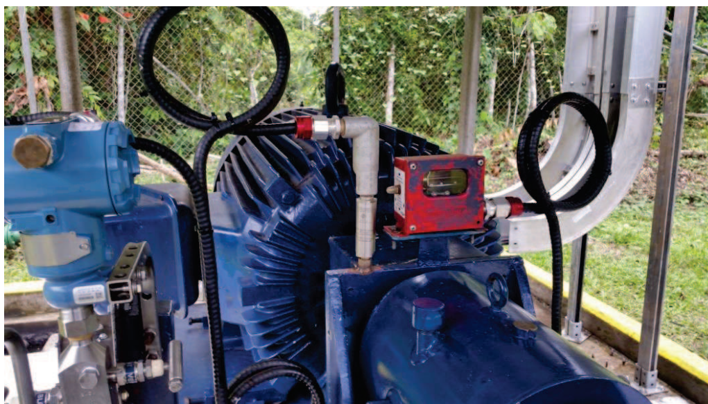
Figura 35: Sistema de protecciones para vibración
