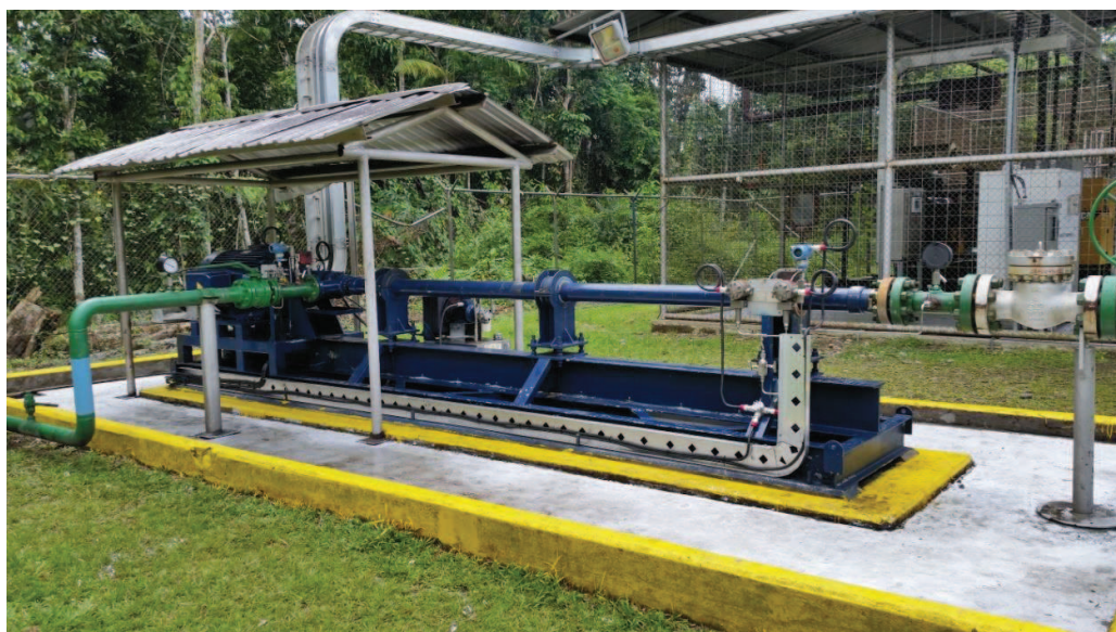
Figura 27: Sistema de Inyección de Agua PYM H
