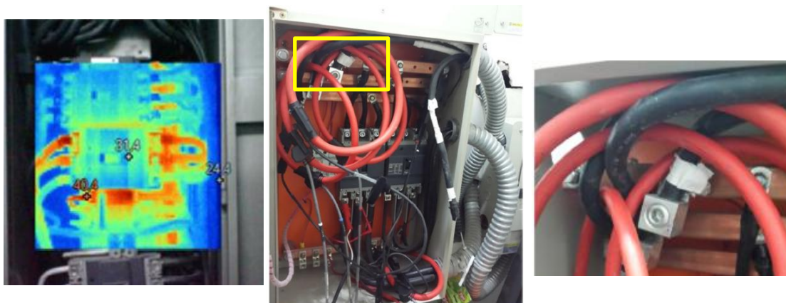
Figura 35 Breaker Piso 9 y tablero Eléctrico Piso 9
