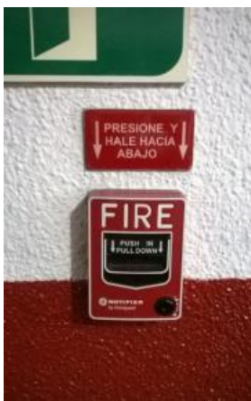
Figura 41 Sistema de alarma Edificio La Previsora
