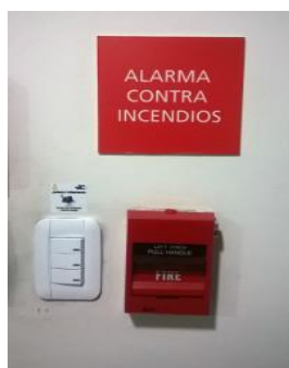
Figura 40 Estación manual y señalética Oficinas BHI Quito
