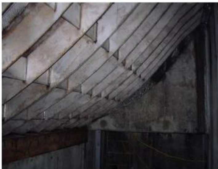
Fotografía 2.5: Parte inferior de la malla autolimpiante.
