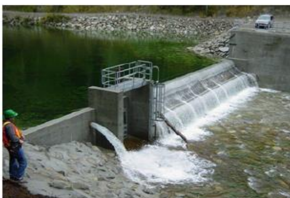
Fotografía 2.7: Obra de captación en pleno funcionamiento, captando agua.
