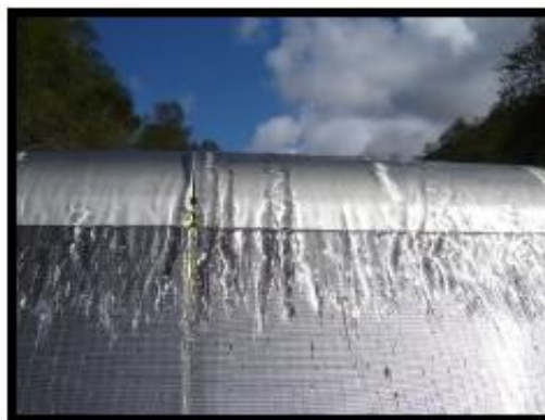
Fotografía 2.3: Captación con pantalla tipo COANDA.
