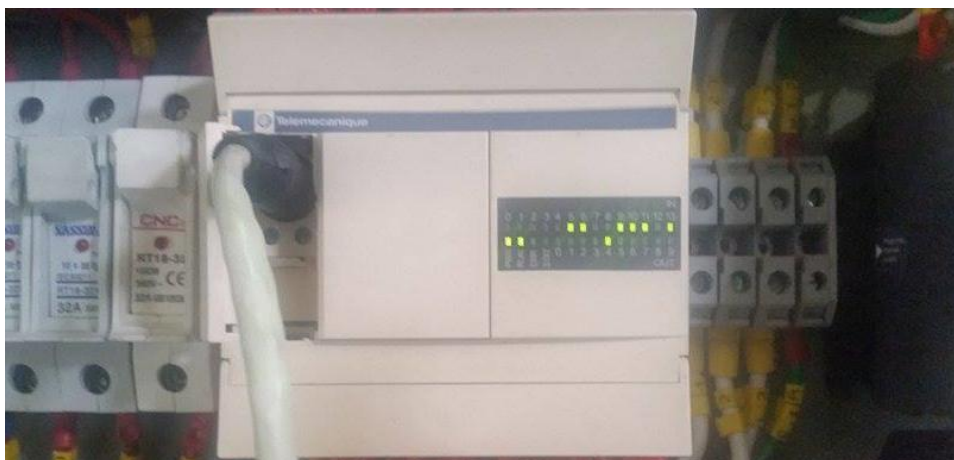
Figura 122. PLC encendido correctamente.
