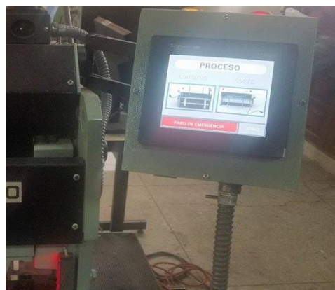
Figura 124. Touch – Panel en correcto funcionamiento.
