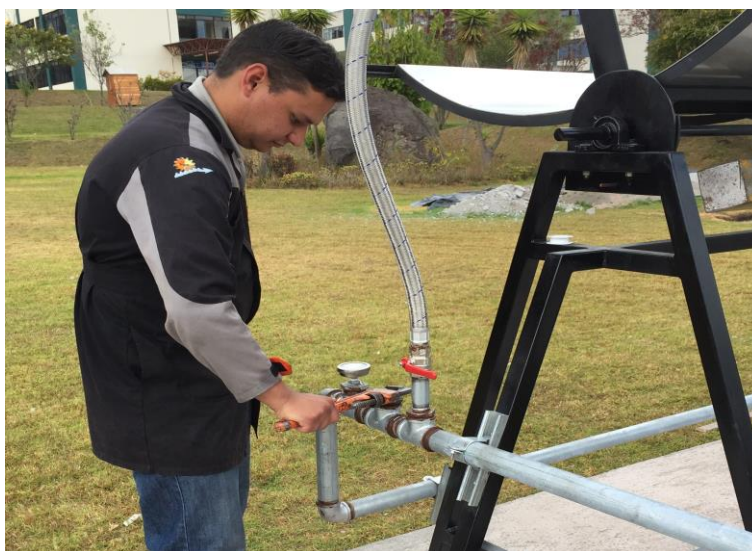
Figura 122. Instalación de los instrumentos de medición.
