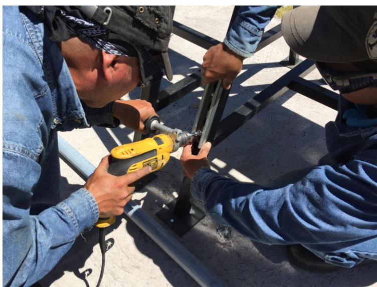
Figura 111. Ubicación de la riel sobre un tubo de la estructura base.
