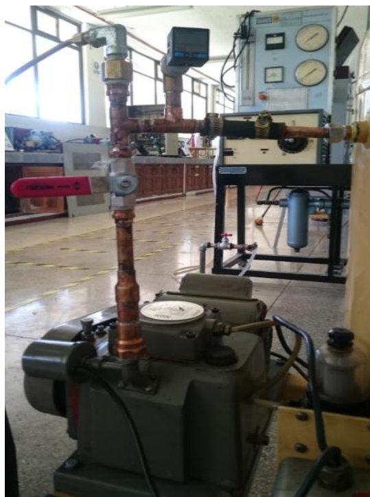
Figura 40 Conexiones de Tuberías Actuales
