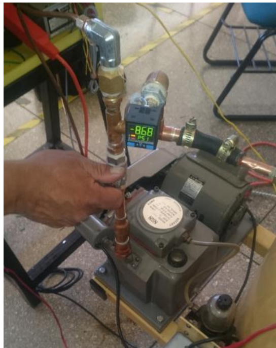
Figura 73 Valor de Presión del sensor SPAB al abrir la válvula de paso
