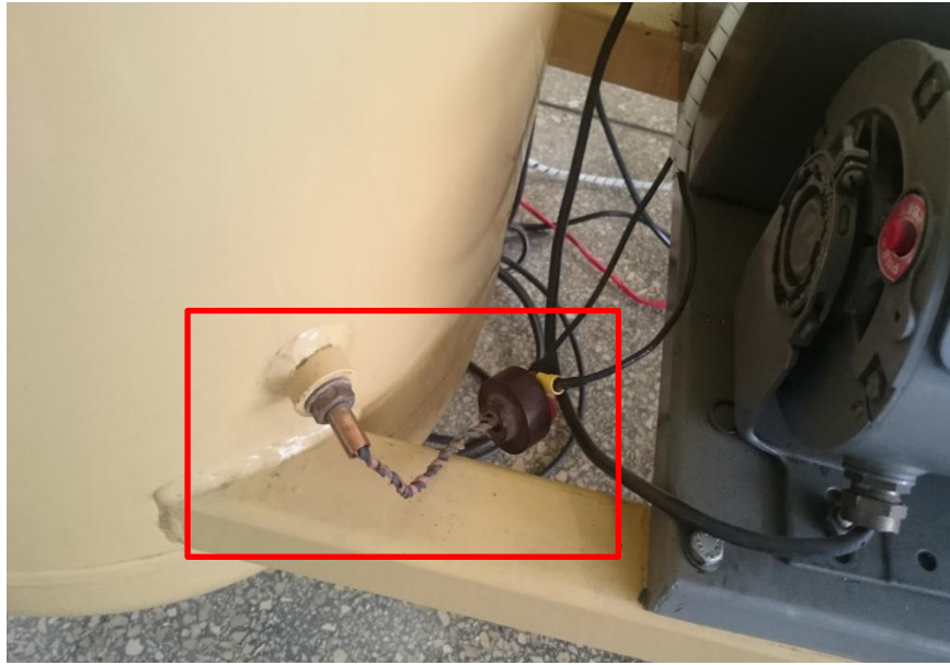
Figura 43 Termocupla Tipo K del Contenedor Corroída y Desatornillada
