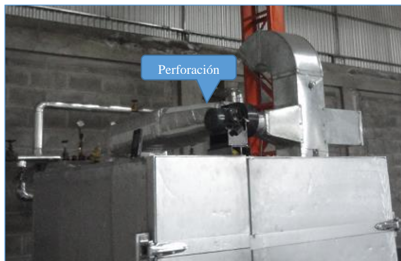
Figura 4-16 Cámara de secado
