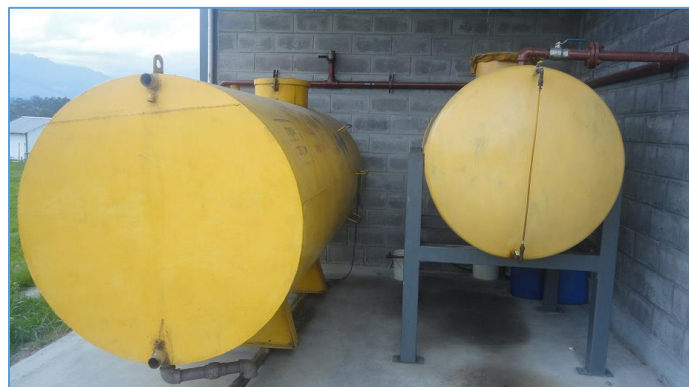
Figura 2-10 Tanques de almacenamiento de diésel
