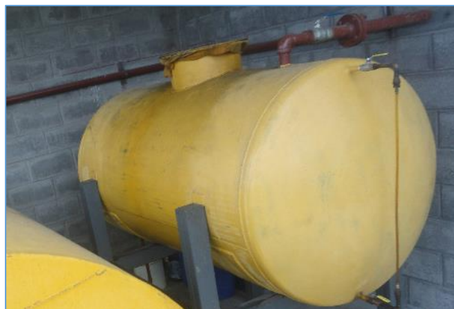
Figura 2-12 Conexión de la línea de llenado al tanque
