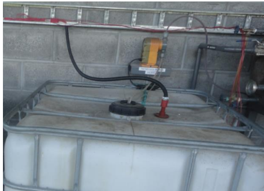
Figura 4-10 Instalación de los sensores de nivel en un tanque de químico
