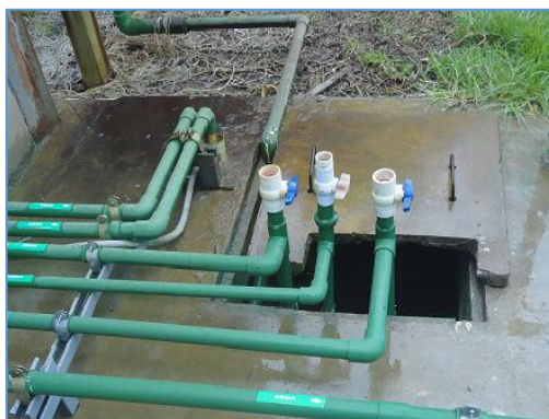
Figura 2-3 Cisterna de Tratamiento
