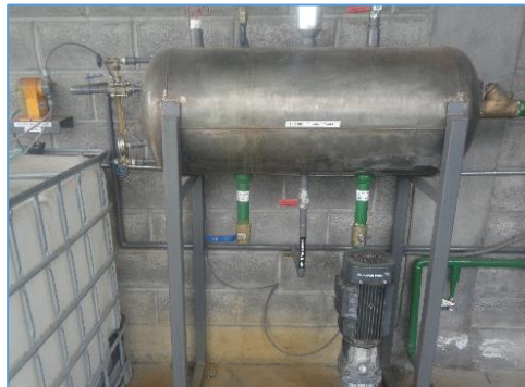
Figura 2-16 Tanque de condensados
