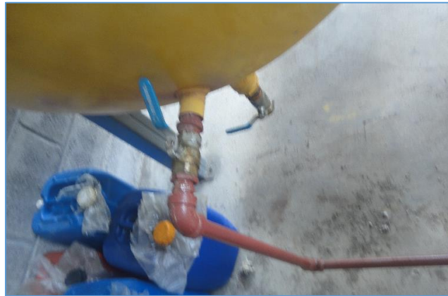
Figura 2-13 Válvula de bloqueo de la línea de vaciado
