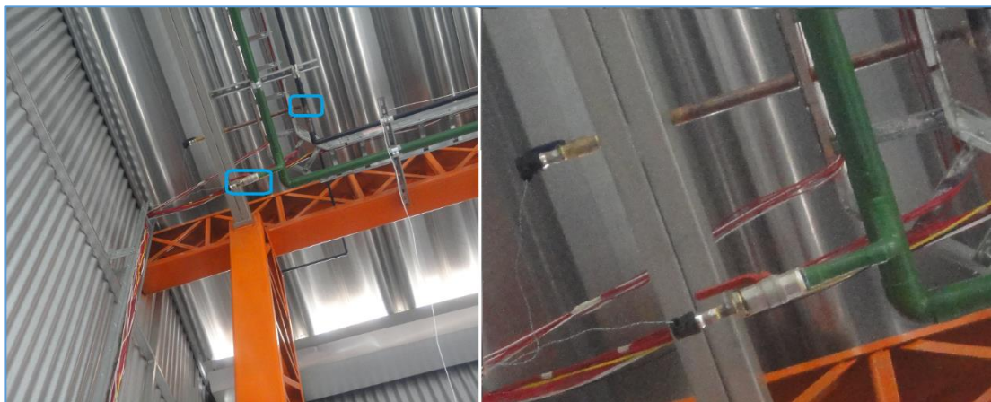
Figura 4-18 Transmisores de presión para las líneas de distribución de aire comprimido y agua
