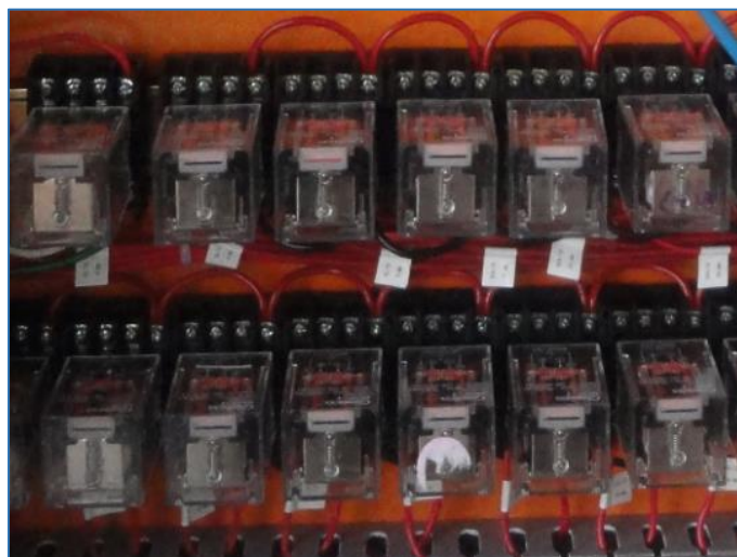
Figura 4-7 Etiquetado de los terminales de los cables para los relés
