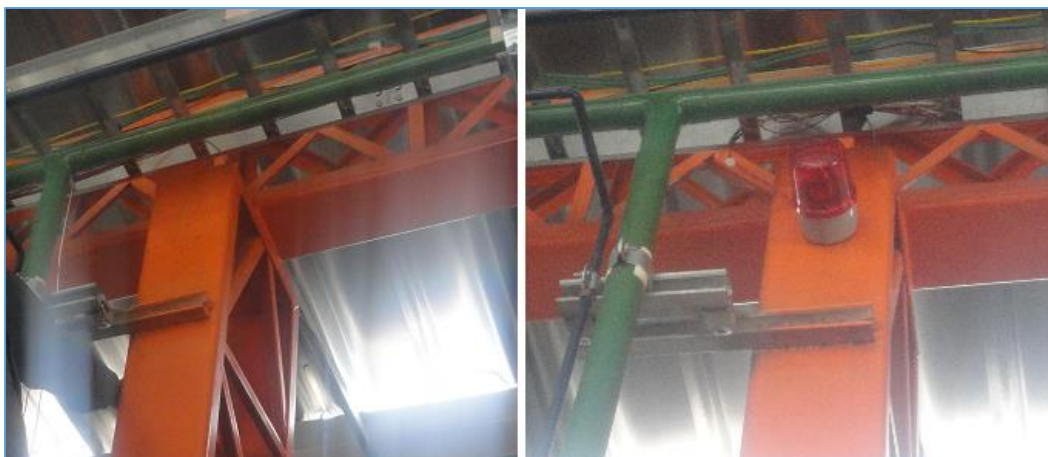
Figura 4-21 Instalación de la baliza
