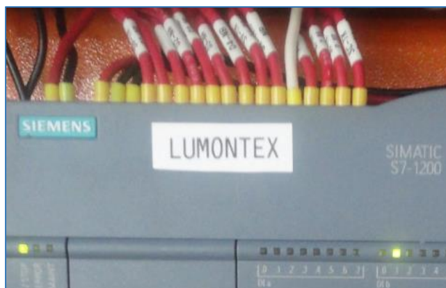
Figura 4-6 Etiquetado de los terminales de los cables del PLC
