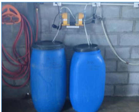
Figura 2-5 Bombas dosificadoras y tanques de químicos
