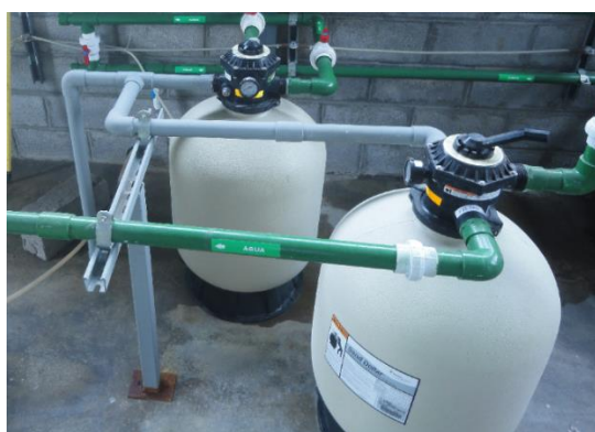
Figura 2-6 Filtros de Arena 1(izq.) - 2(der.)
