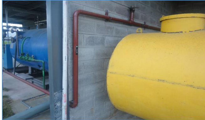
Figura 2-11 Línea de llenado para los tanques de diésel
