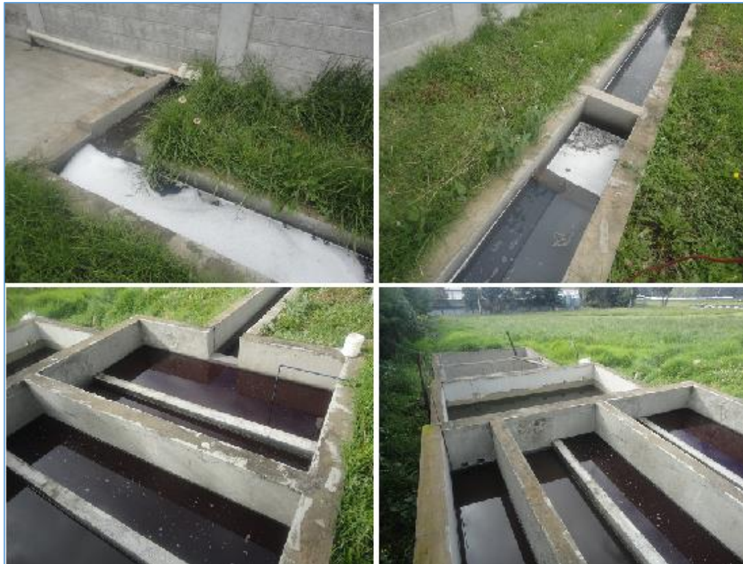
Figura 2-18 Canal y piscinas para el tratamiento de aguas residuales
