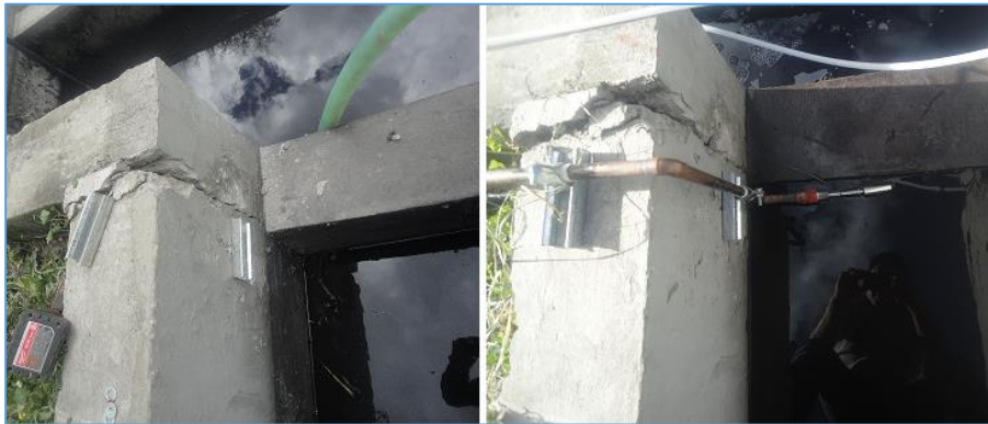
Figura 4-13 Instalación del sensor de nivel para el tratamiento de aguas residuales
