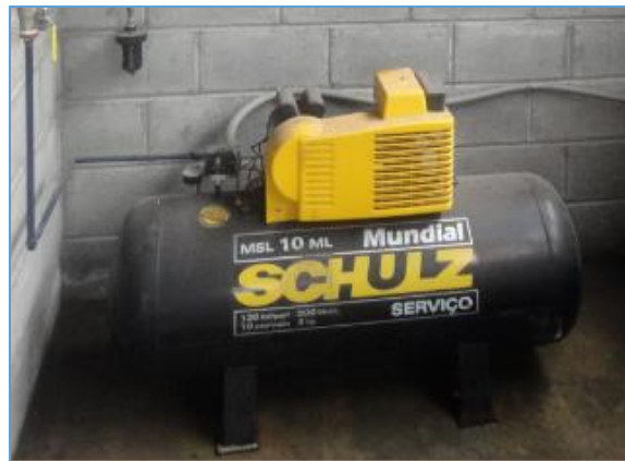
Figura 2-19 Compresor de aire para el tratamiento de aguas residuales
