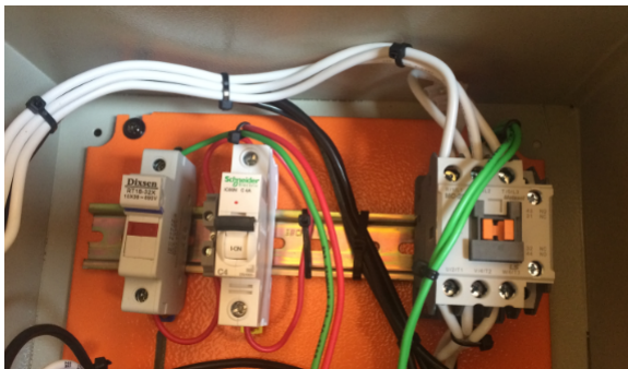
Figura 30: Montaje fusible, disyuntor y contactor sistema gasificador
