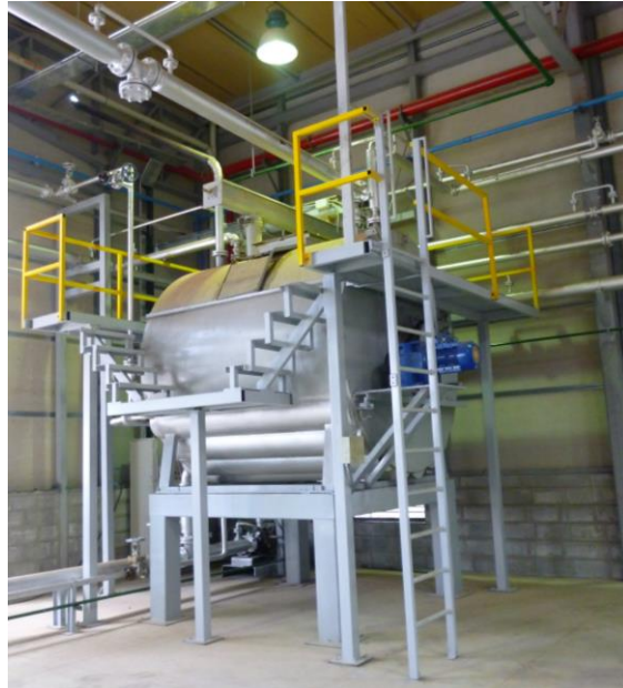
Figura 164. Estación de mezclado
