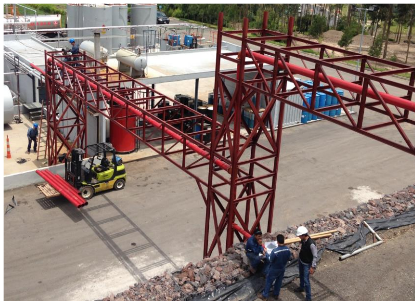
Figura 46. Rack de tuberías
