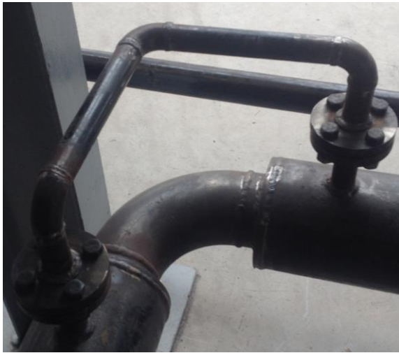
Figura 159. Conexiones de aceite térmico
