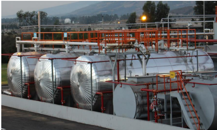
Figura 10. Recipientes de almacenamiento de asfalto
