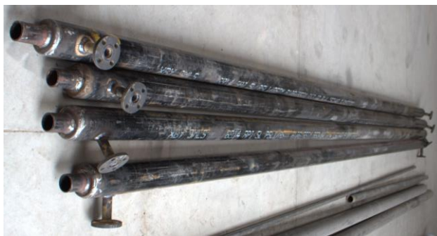
Figura 154. Tuberías para productos asfálticos
