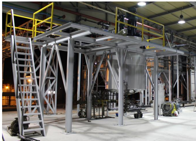
Figura 163. Estación de premezcla
