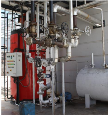
Figura 166. Bomba de aceite térmico y zona de calderos
