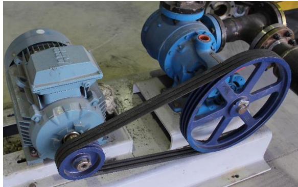
Figura 170. Bomba de recirculación
