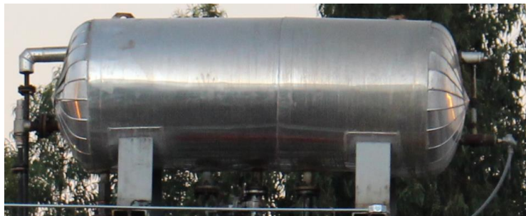
Figura 23. Tanque de expansión Chova del Ecuador S.A.
