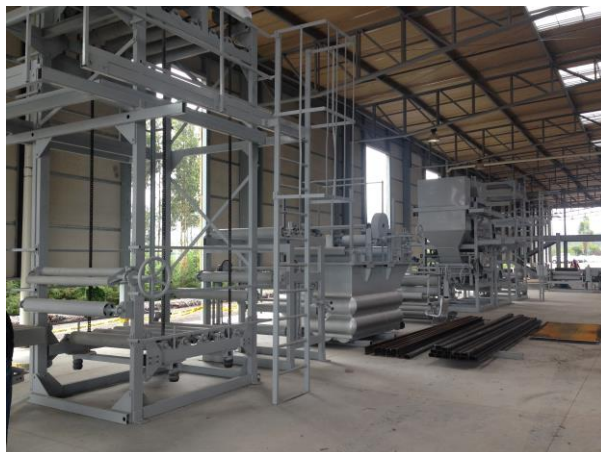
Figura 15. Línea de producción de láminas impermeabilizantes
