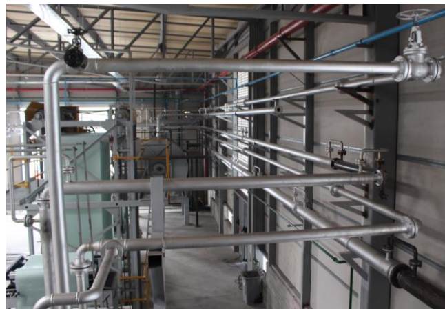
Figura 165. Red de Tuberías de aceite térmico, asfalto AC20 y Asfalto modificado
