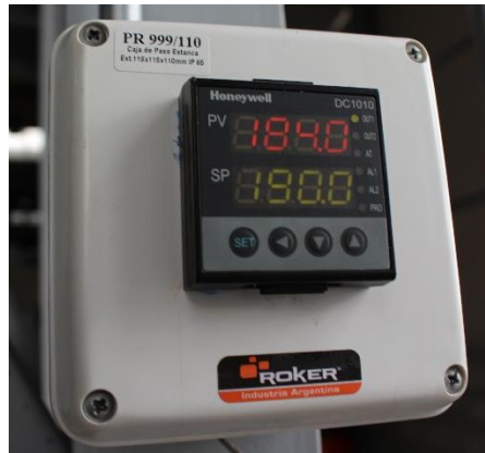
Figura 172. Tablero de temperatura premezclador
