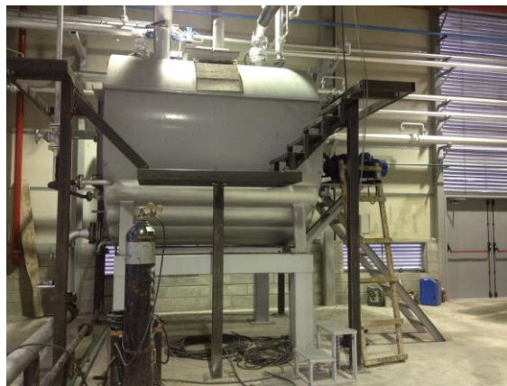
Figura 145. Escaleras para evitar tubería
