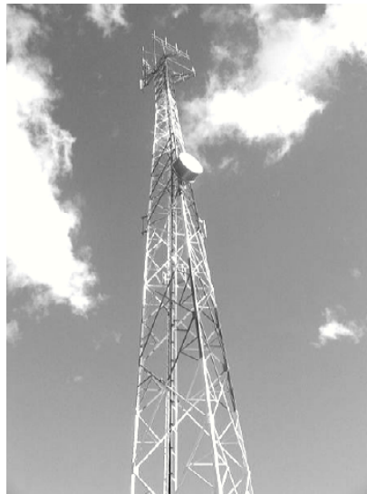
Figura. 2.5. Antena de estación central
