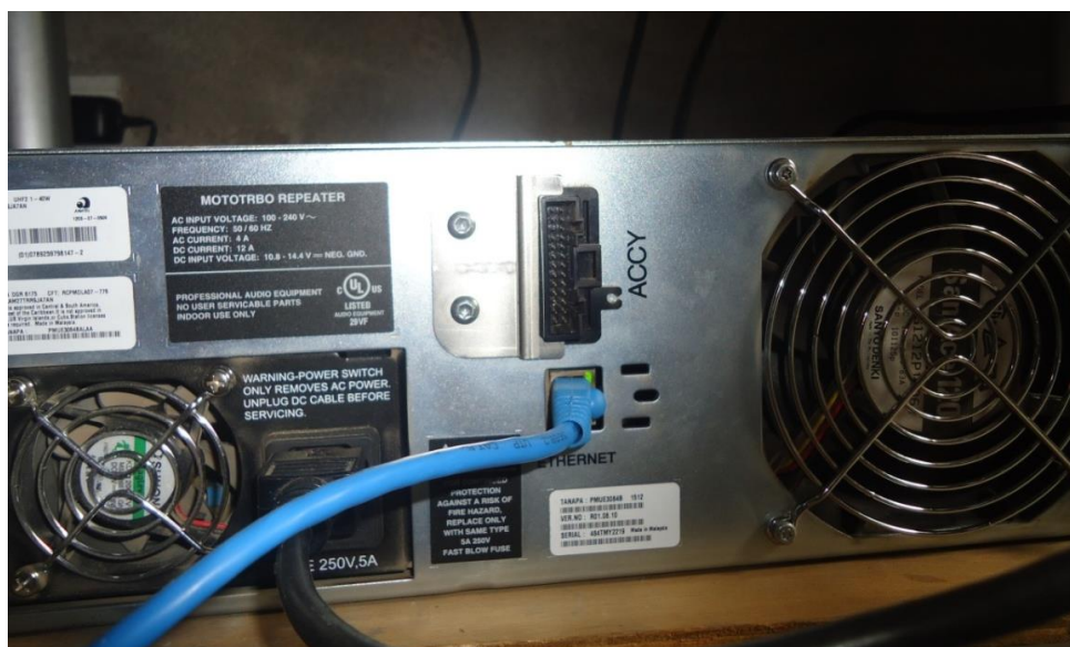
Figura 3. 44. Repetidor DGR 6175 instalado en el cerro Monjas
