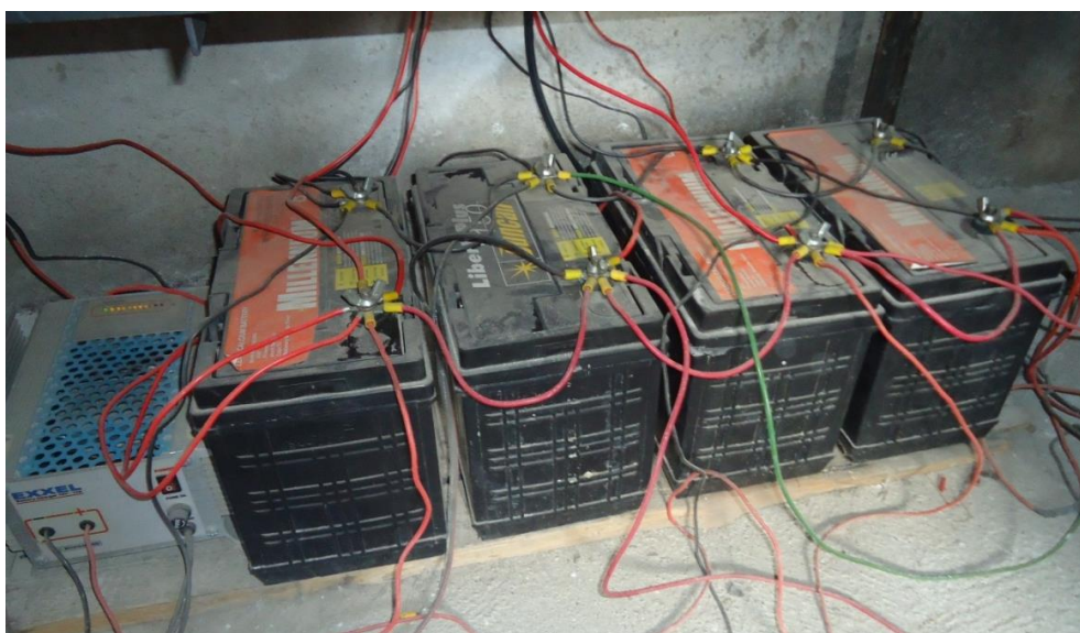
Figura 3. 45. Banco de baterías de respaldo
