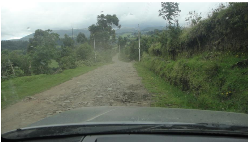
Figura 46 Vía empedrada de mal estado, Rumipamba, Marzo 2015. Coordenadas: Z17S, 785551mE, 9957243mS, 2765m.s.n.m.
