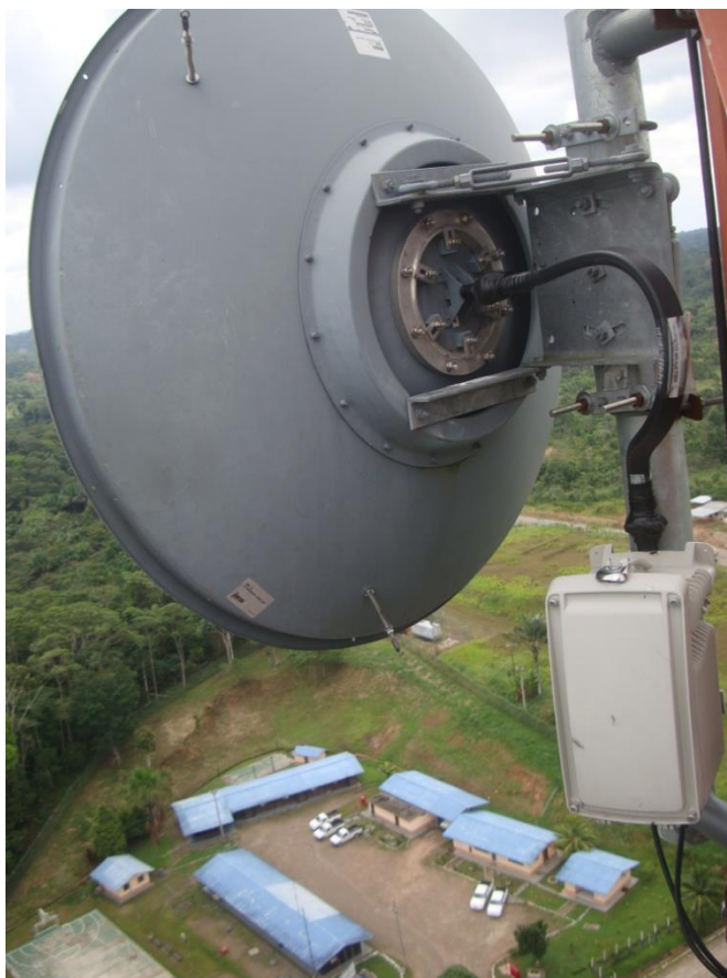
Figura 3.3 Equipo Truepoint en torre Tipishca
