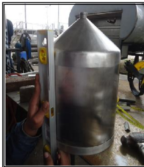
Fuente: Grupo de investigación Figura 4.39 Cilindro principal del reactor.
