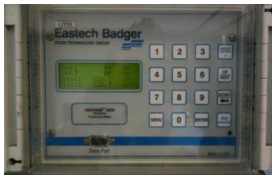
Figura 27. Indicador de nivel Vantage 2220 de los tanques de mezcla.
