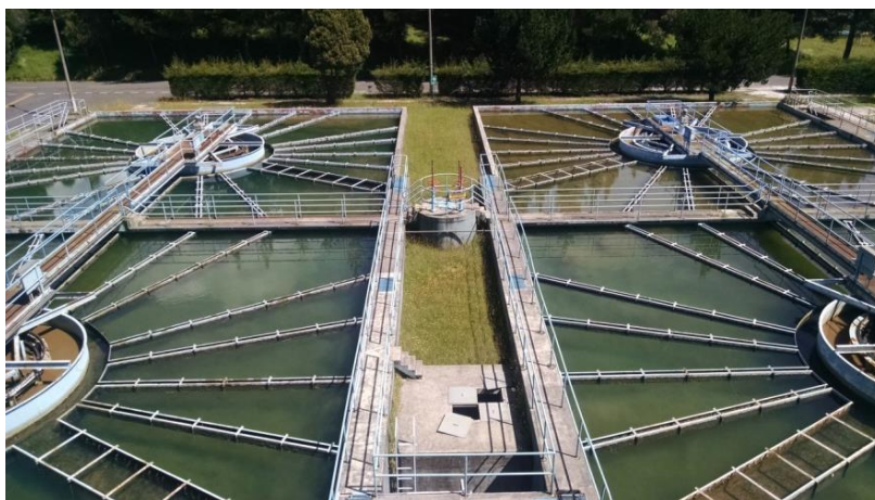
Figura 9. Clarificadores rectangulares Planta de Tratamiento Puengasí.
