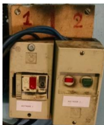
Figura 29. Arrancadores de motores para mezcla de polímero.
