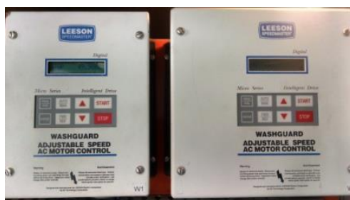
Figura 42. Variadores de frecuencia del sistema de dosificación de sulfato.
