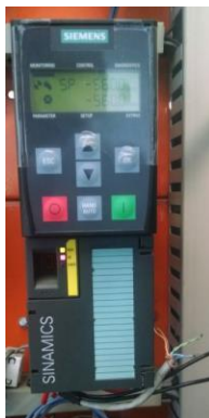
Figura 50. Variador Siemens desconectado del PLC.
