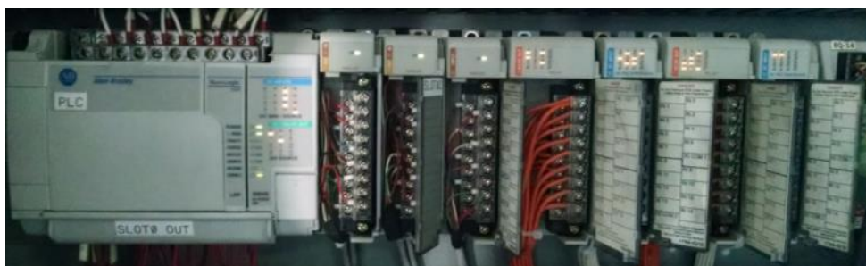
Figura 33. PLC MicroLogix 1500 del área de polímero.
