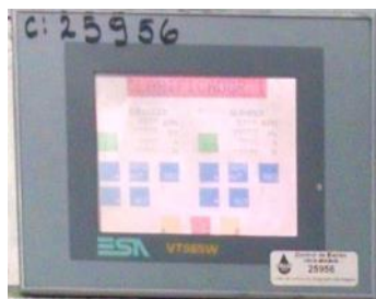
Figura 52. Pantalla táctil para control del área de clarificadores.
