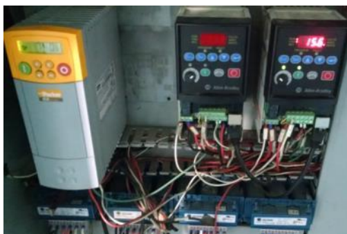
Figura 35. Variadores de frecuencia de la dosificación de polímero.
