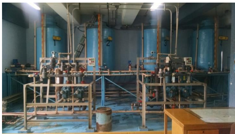
Figura 6. Tanques y bombas para la dosificación de sulfato de aluminio.
