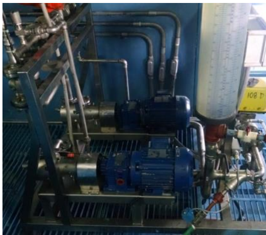
Figura 32. Sistema de bombas para dosificación de polímero.
