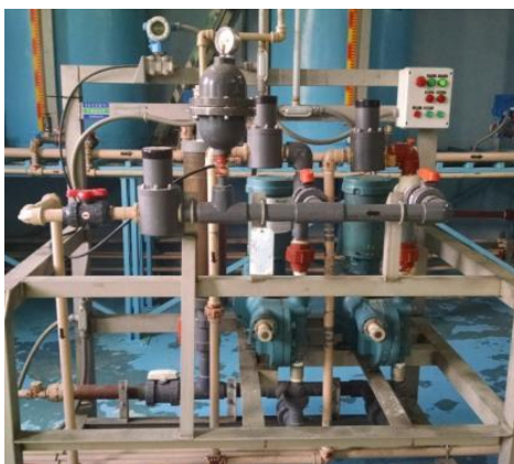
Figura 41. Sistema de dosificación de sulfato de aluminio.
