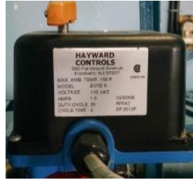
Figura 30. Electroválvula para llenado de los tanques de mezcla.
