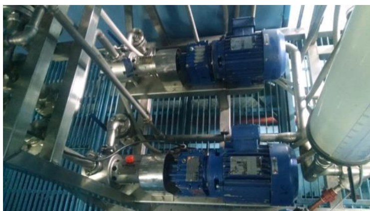
Figura 8. Sistema de Bombas para dosificación de polímero.
