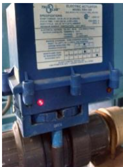
Figura 40. Electroválvulas para llenado de tanques de sulfato.
