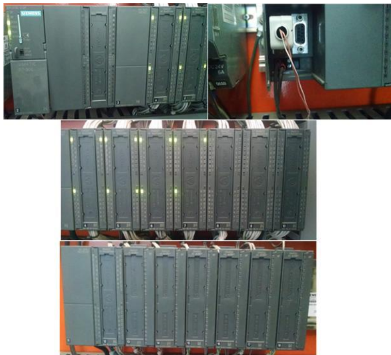
Figura 49. PLC S7-300 del área de clarificadores.
