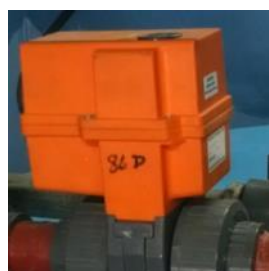
Figura 31. Electroválvula de los tanques de dosificación de polímero.
