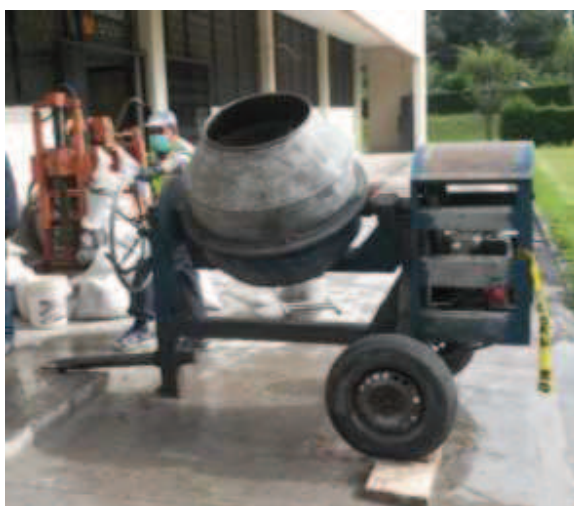
Figura 34. Mezclador estacionario inclinado utilizado en la fundición.
