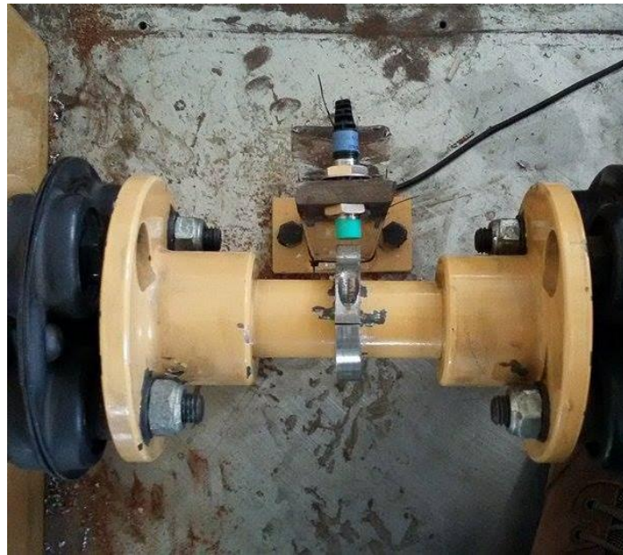
Figura 3.7. Instalación sensor inductivo
