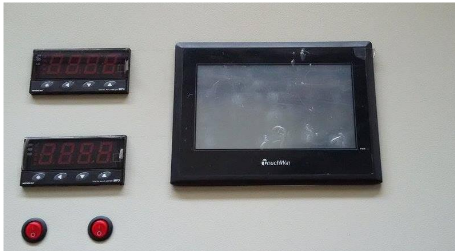
Figura 3.10. Tablero de control Interfaz HMI
