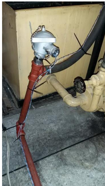
Figura 3.3. Instalación PT100 en la línea de refrigeración
