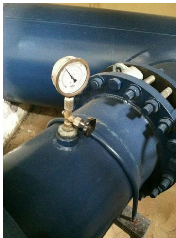
Figura 37 Manómetro ubicado a la salida de un grupo de bombeo, estación El Ceibal
