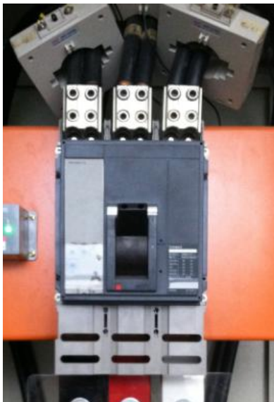
Figura 104. Schneider Compact NS800N, conexión y montaje en la estación Río de Oro
