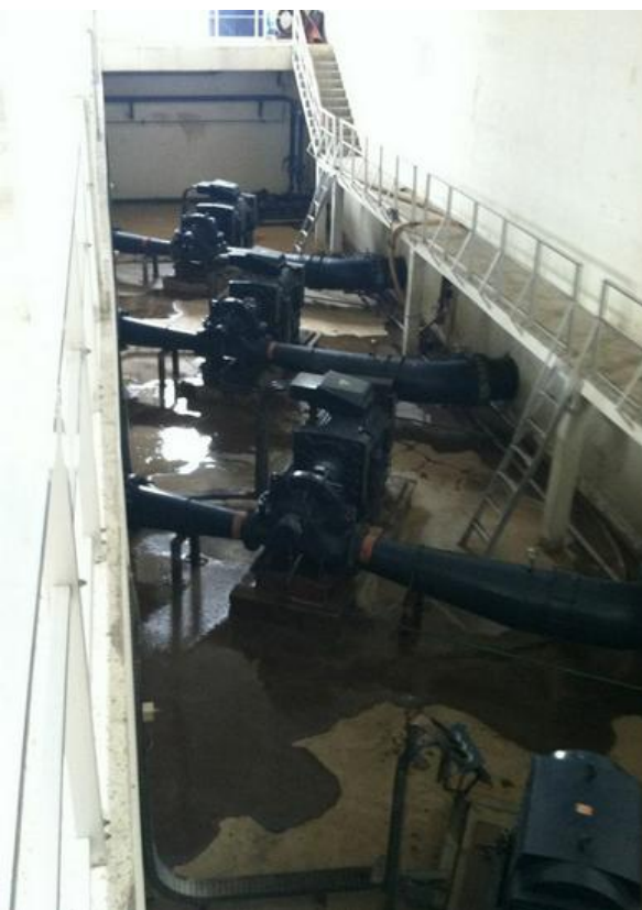
Figura 1 Estación de bombeo Caza Lagarto
