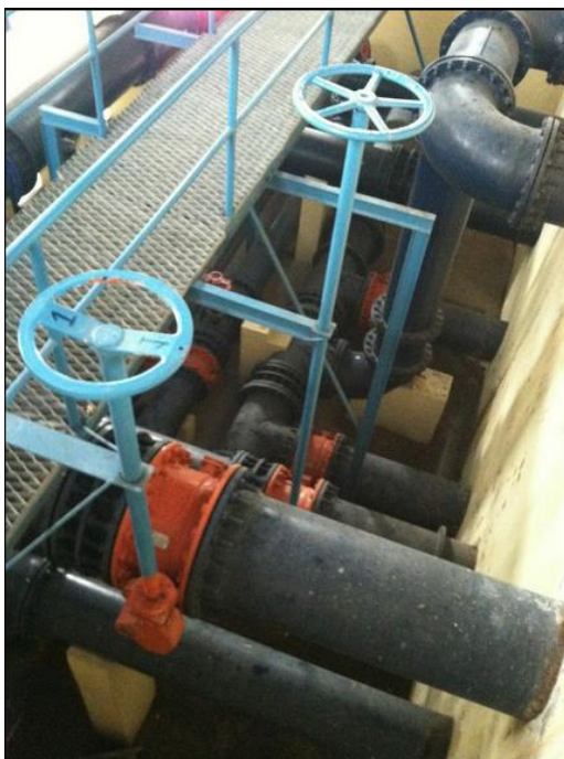
Figura 2 Tanque Cruz Verde, capacidad 5000 m^3
