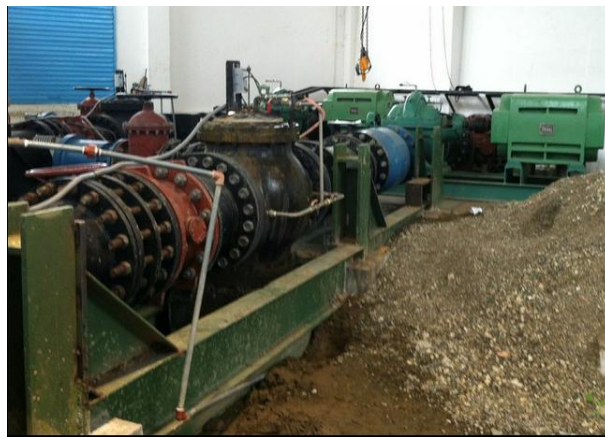
Figura 8 Estación de bombeo Río de Oro
