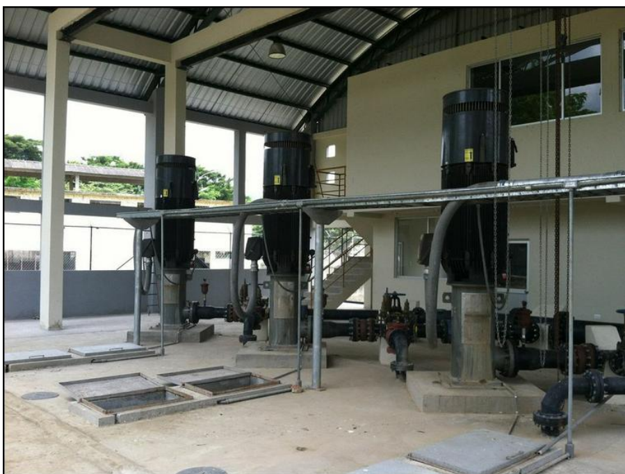
Figura 5 Estación de bombeo Caza Lagarto.
