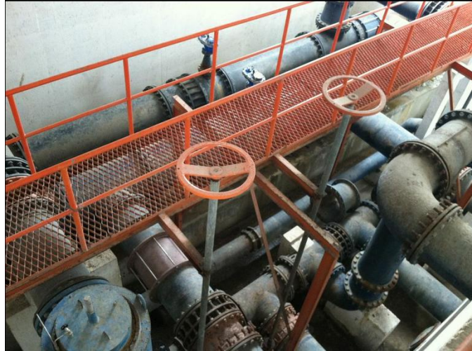
Figura 3 Tanque Intermedio, capacidad 5000 m 3
