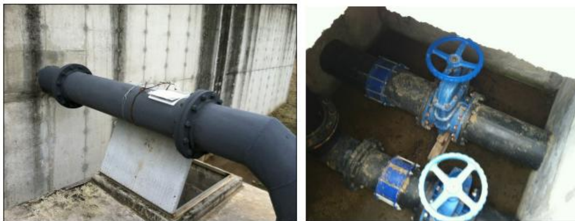
Figura 6 Tanque del cerro el Mocochoal, Carga y Descarga, capacidad 1000\text{ m}^3
