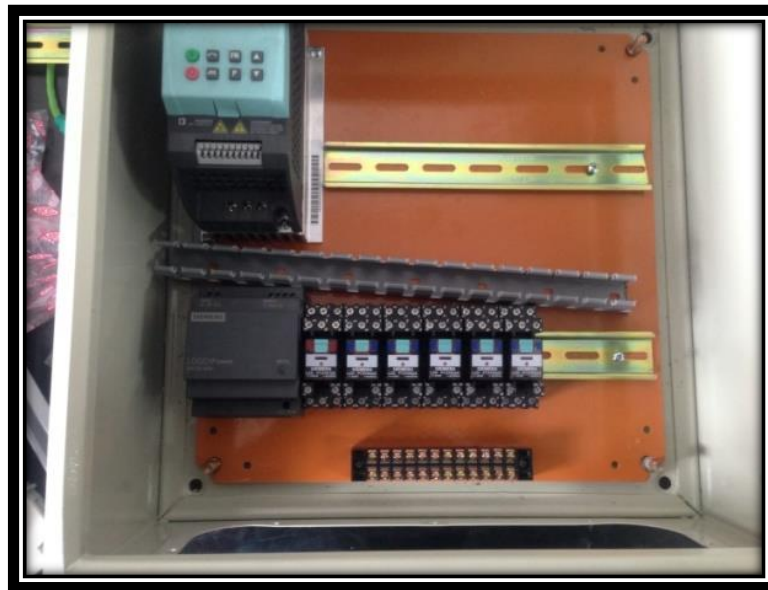
FIGURA 67 Montaje de riel DIN con equipos
