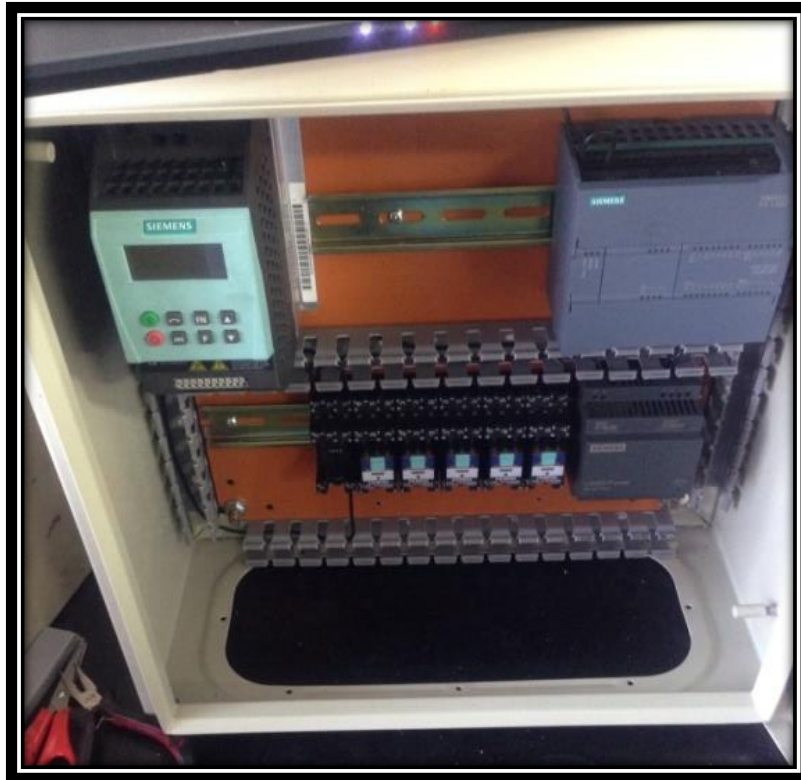
FIGURA 68 Distribución de equipos eléctricos y electrónicos
