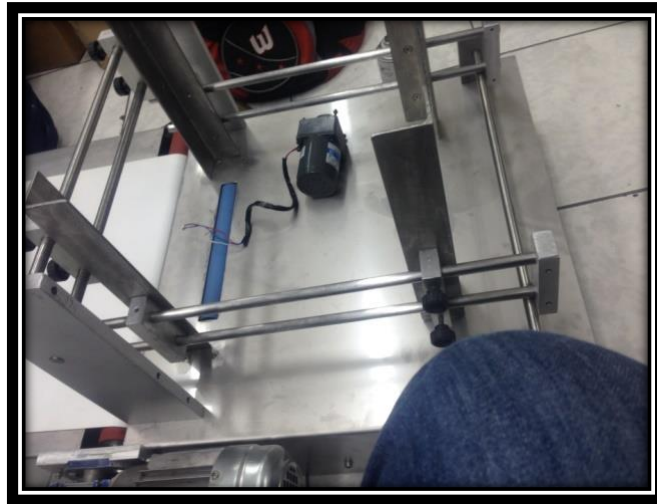
FIGURA 53 Motor de arrastre fuera de la instalación
