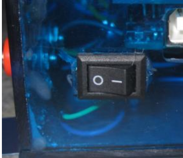
Figura 49. Encendido/Apagado de todo el sistema de control
