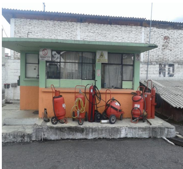
Figura 22, COLOG, Área de extintores.
