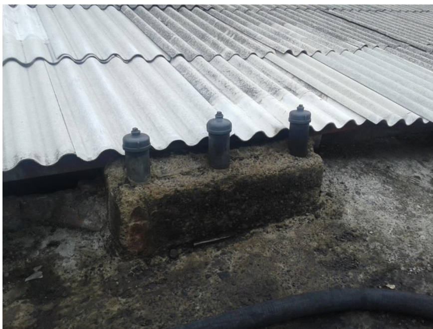
Figura15, Tomas de llenado de combustible.
