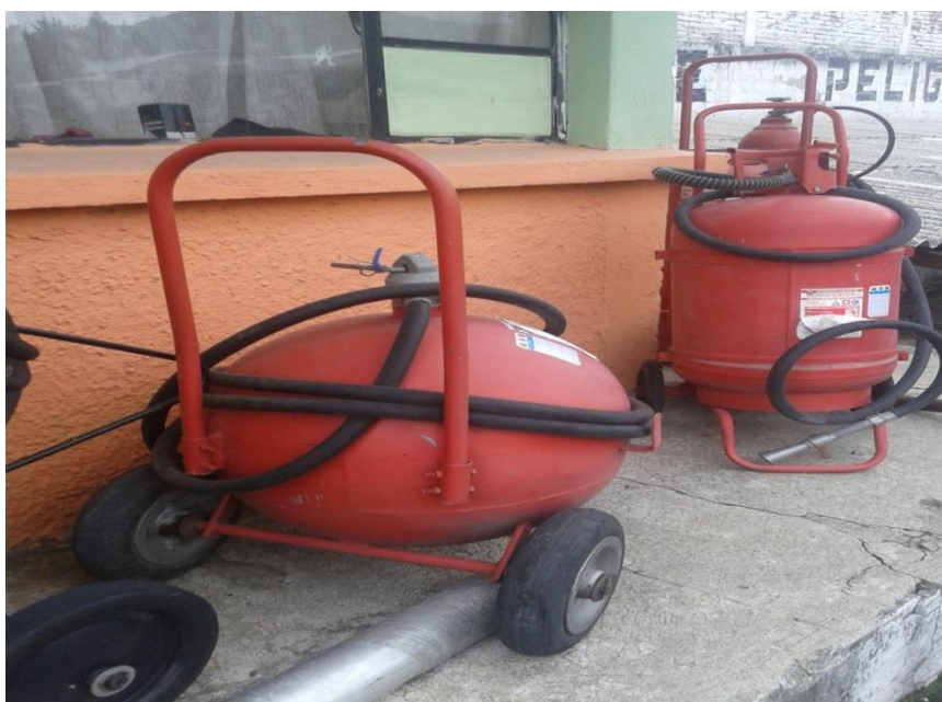
Figura17, Grupo de extintores.
