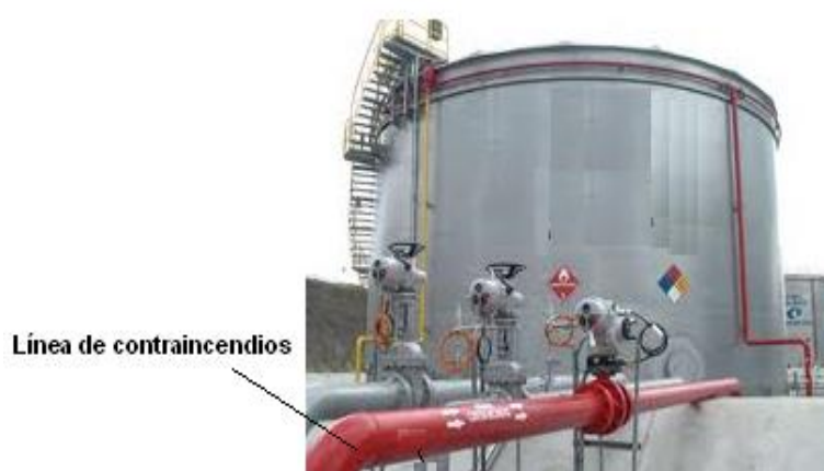
Figura 07, Línea contraincendios en tanque de almacenamiento.
