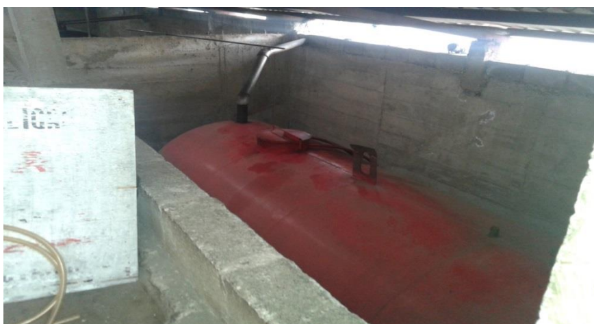
Figura14, Tanque de gasolina 5000 galones.
