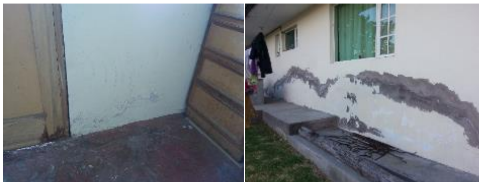
Figura 92. Problemas de humedad en paredes de viviendas
