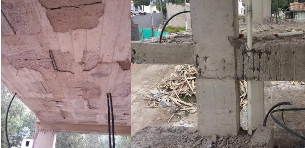
Figura 43. Mala colocación de acero en una losa y viga.
