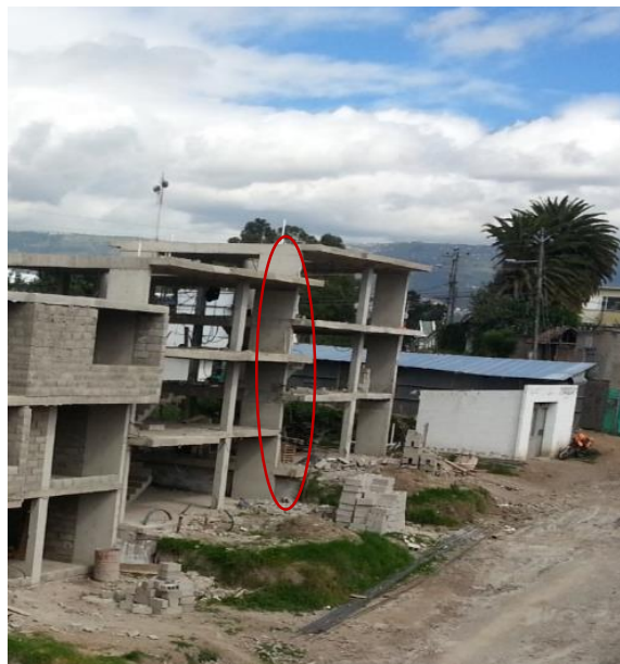
Figura 39. Columna corta Proyecto 1.
