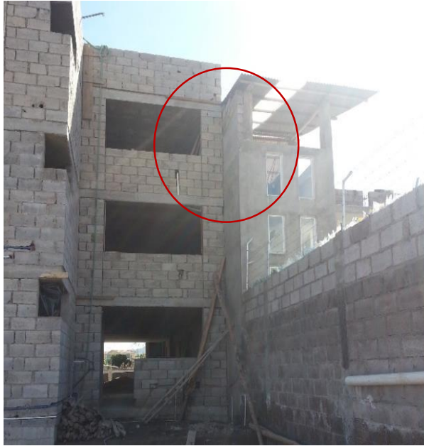
Figura 46. Inexistencia de juntas sísmicas entre estructuras.
