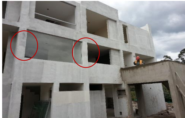
Figura 38. Columna corta Proyecto 1.
