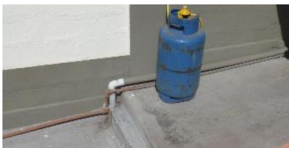
Figura 25. Elementos de conducción expuestos.
