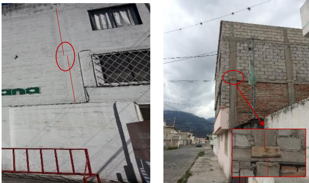
Figura 21. Ejes de columnas desfasados en edificaciones visitadas.
