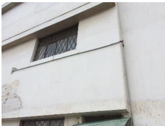
Figura 24. Elementos de conducción expuestos.
