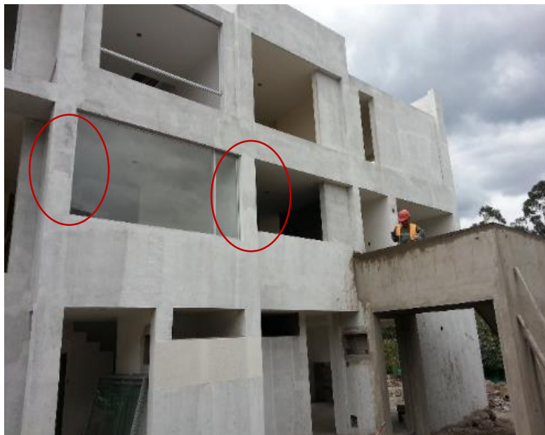
Figura 99. Problemas de columna corta en una vivienda.
