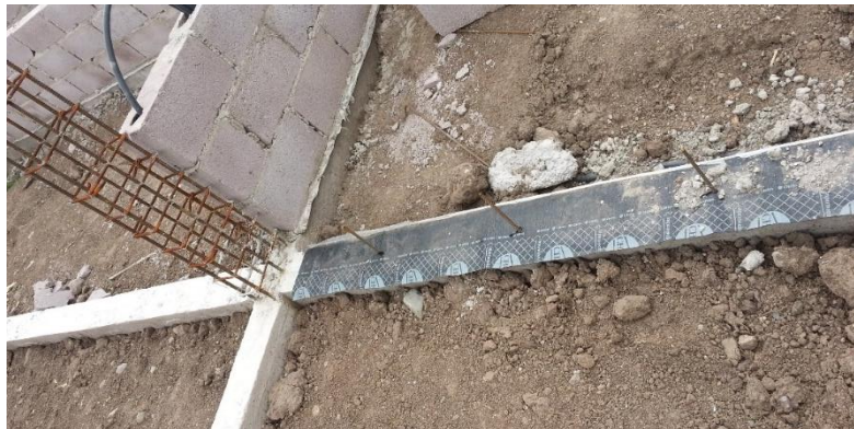
Figura 93. Lámina de impermeabilización
