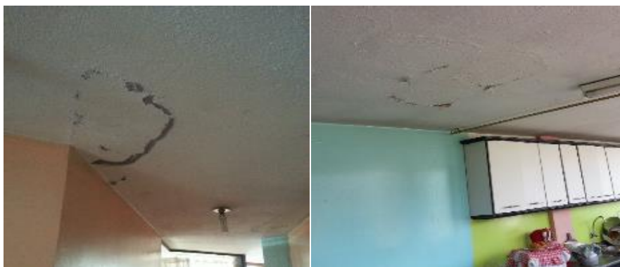
Figura 15. Problemas de humedad en losas de viviendas visitadas.
