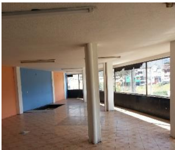
Figura 23. Elementos de conducción expuestos.
