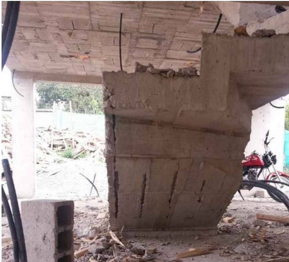
Figura 44. Inexistencia de recubrimientos en una grada.
