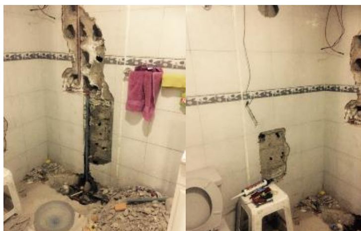
Figura 16. Problemas de humedad en paredes de viviendas visitadas por tubería de mala calidad.
