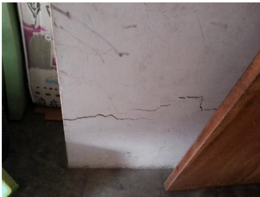
Figura 18. Grietas horizontales en paredes en una vivienda.
