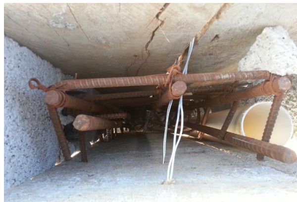
Figura 47. Inadecuada sujeción y colocación de acero en un proyecto.
