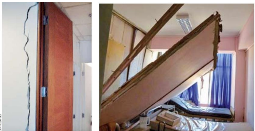
Figura 83 Desprendimiento de tabiques Sismo Chile 2010
