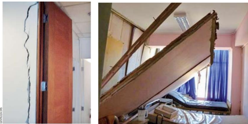
Figura 9 Desprendimiento de tabiques Sismo Chile 2010
