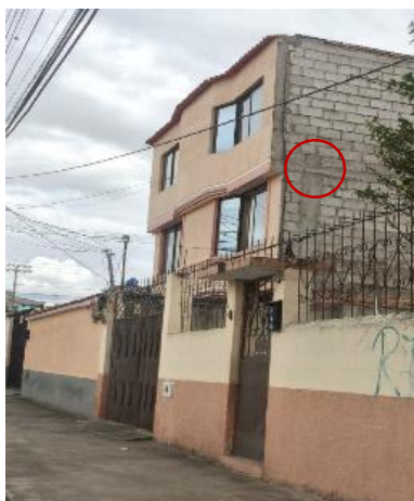
Figura 22. Discontinuidad en columnas en edificaciones visitadas.
