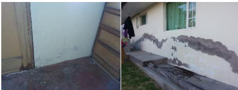
Figura 17. Problemas de humedad en paredes de viviendas visitadas.
