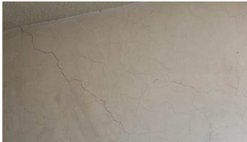
Figura 96. Fisuras en una vivienda.
