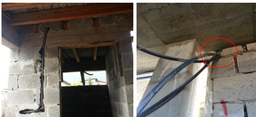
Figura 45. Vigas atravesadas por tuberías en proyectos.
