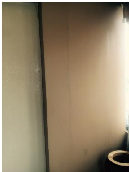
Figura 19. Grietas verticales en paredes en una vivienda.
