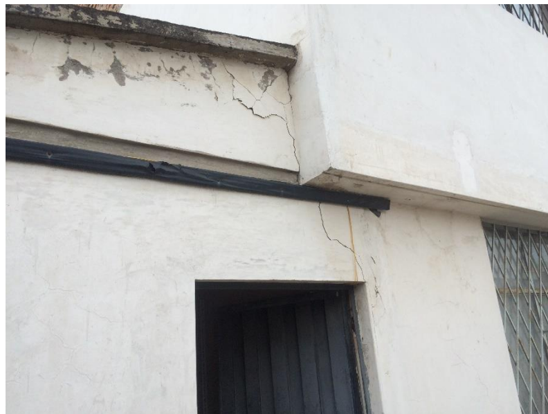
Figura 97. Grietas por inexistencia de junta en una vivienda.
