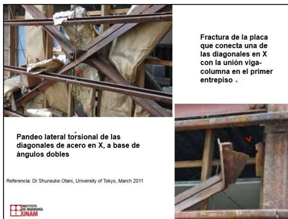
Figura 28. Fallas en Juntas Soldadas Edificio en Sendai, Japón
