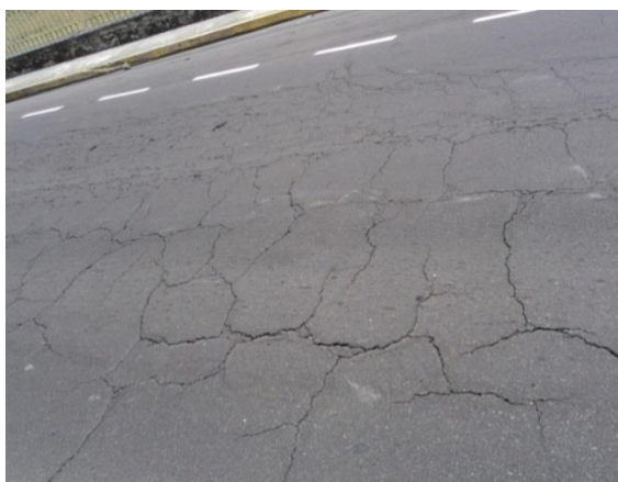
Figura 3. Fisura en bloque.
