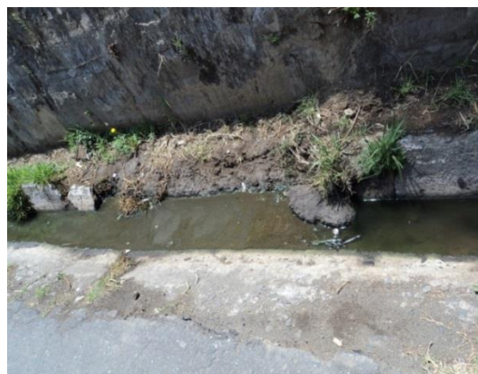
Figura 61. Inadecuado Proceso de Mantenimiento.
