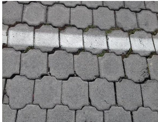
Figura 25. Falla Desplazamiento de Junta.
