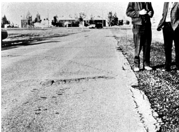
Figura 4. Falla tipo Abultamiento
