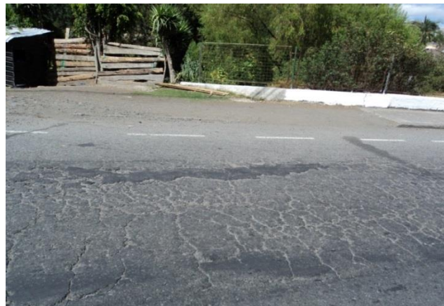
Figura 45. Parcheo de corte mal colocado muestra 1
