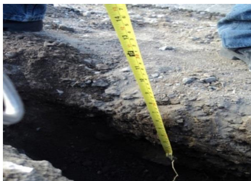
Figura 66 Medición de Espesores.
