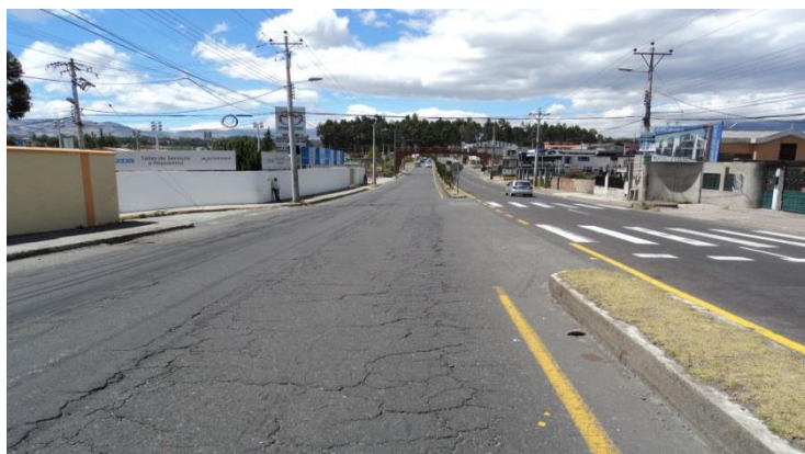
Figura 103. Daño representativo tipo agrietamiento en bloque.
