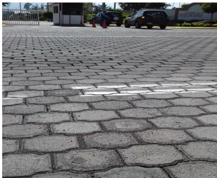
Figura 128. Daño representativa tipo pérdida de arena
