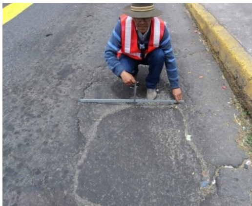
Figura 10. Falla tipo Parqueo de Corte.
