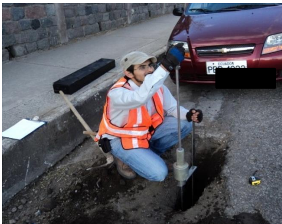
Figura 69 Medición Avenida General Rumiñahui.
