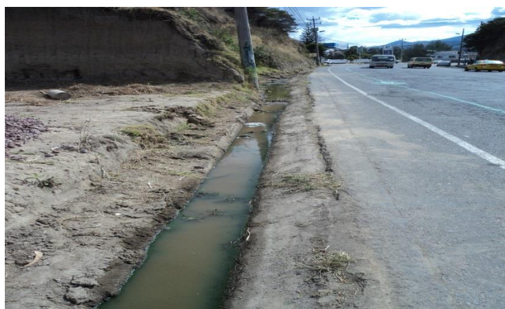
Figura 107. Daño representativo tipo grieta de borde.
