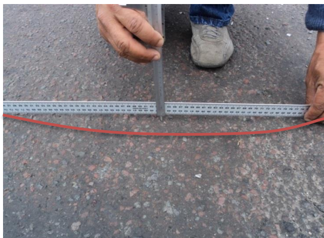
Figura 6. Falla del tipo Depresión.
