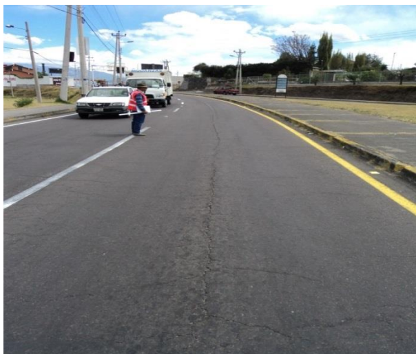
Figura 9. Grietas Transversales y longitudinales.
