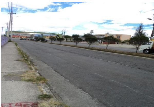
Figura 7. Falla tipo fisura de Borde.
