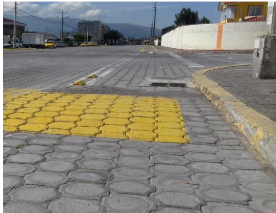
Figura 24. Falla tipo Desplazamiento de Borde
