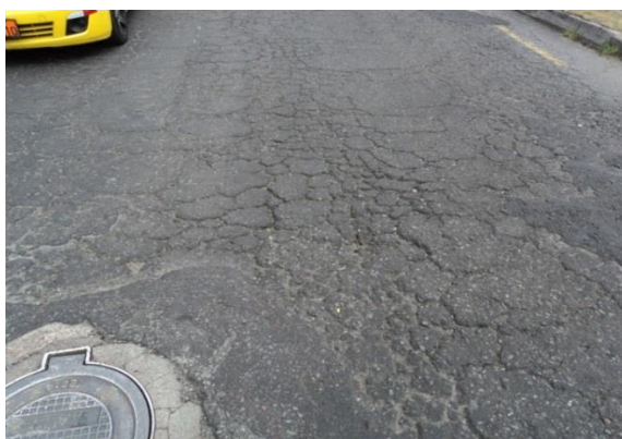
Figura 1. Falla Tipo Piel de Cocodrilo.
