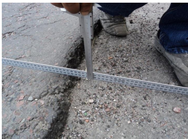
Figura 8. Falla Desnivel Carril – Berma.
