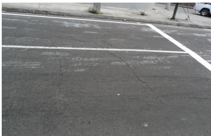
Figura 109. Daño representativo tipo grietas longitudinales.
