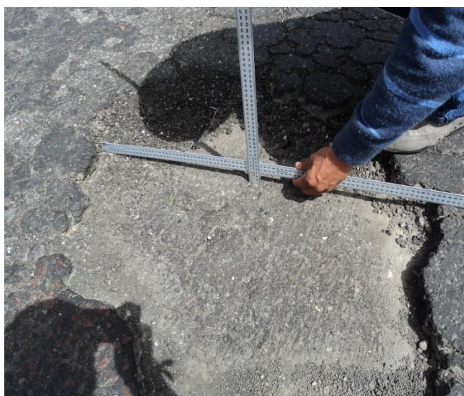
Figura 117. Daño representativo tipo Bache.
