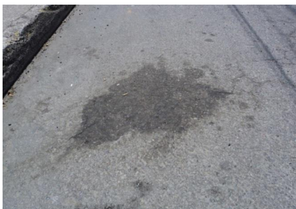
Figura 2. Falla tipo Exudación de Asfalto.
