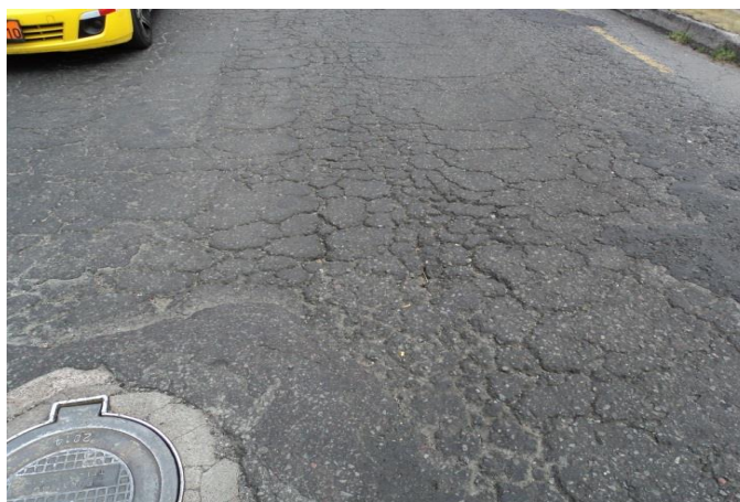
Figura 101. Daño representativo tipo Piel de cocodrilo.
