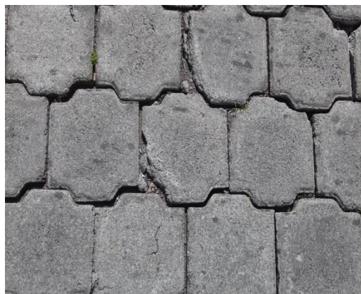
Figura 27. Falla por fracturamiento de confinamiento.
