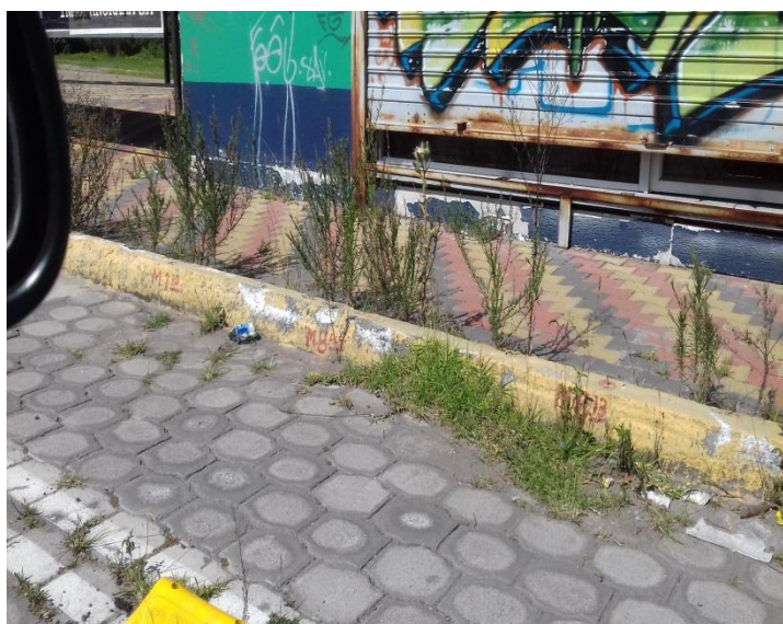
Figura 132. Daño representativo tipo vegetación en calzada.
