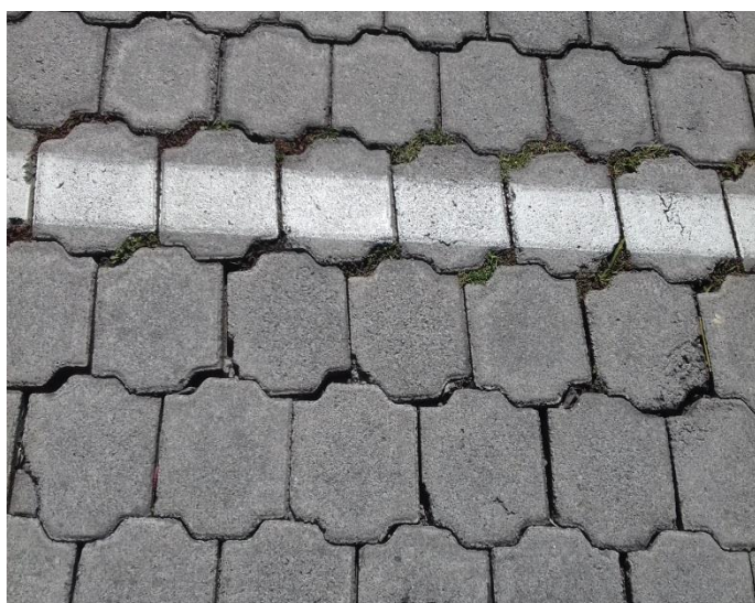
Figura 130. Daño representativo tipo fracturamiento.
