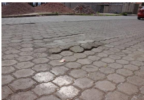
Figura 19. Falla Tipo Abultamiento.
