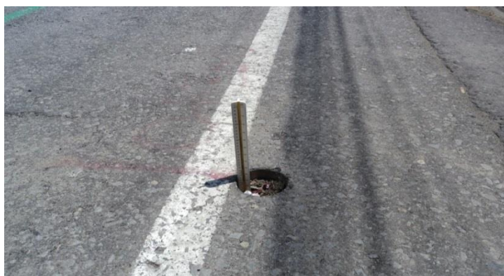
Figura 113. Daño representativo tipo pulimento de agregado.
