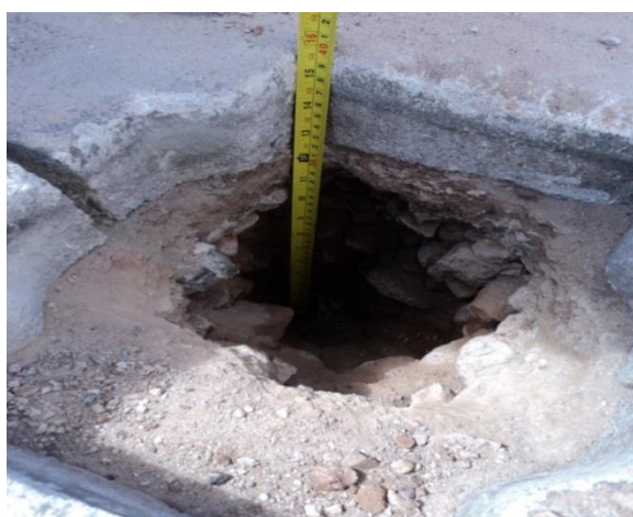
Figura 63. Medición de Espesores.
