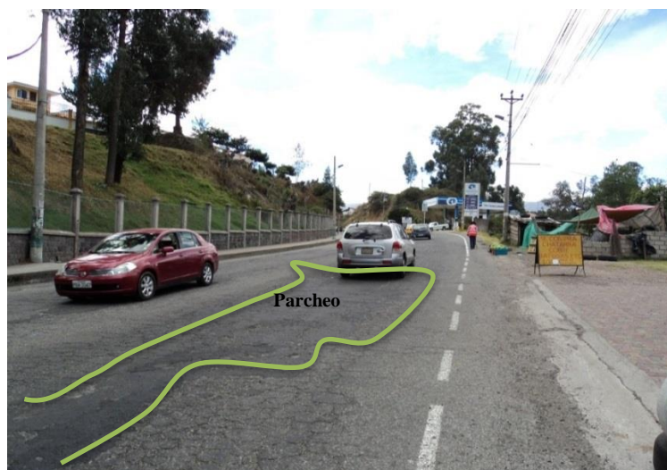
Figura 49. Defectuoso proceso de parcheo de corte.
