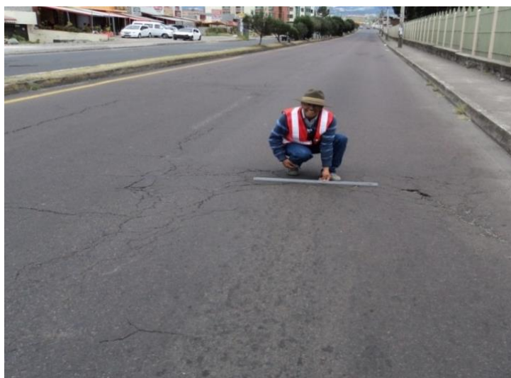
Figura 121. Daño representativo tipo grieta parabólica
