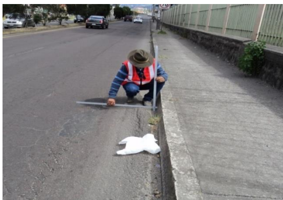
Figura 14. Falla tipo Surco de Huella.
