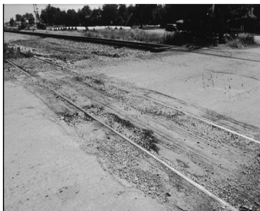
Figura 13. Falla Cruce de Ferrocarril
