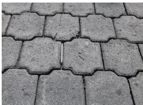
Figura 29. Falla Tipo Junta Abierta.
