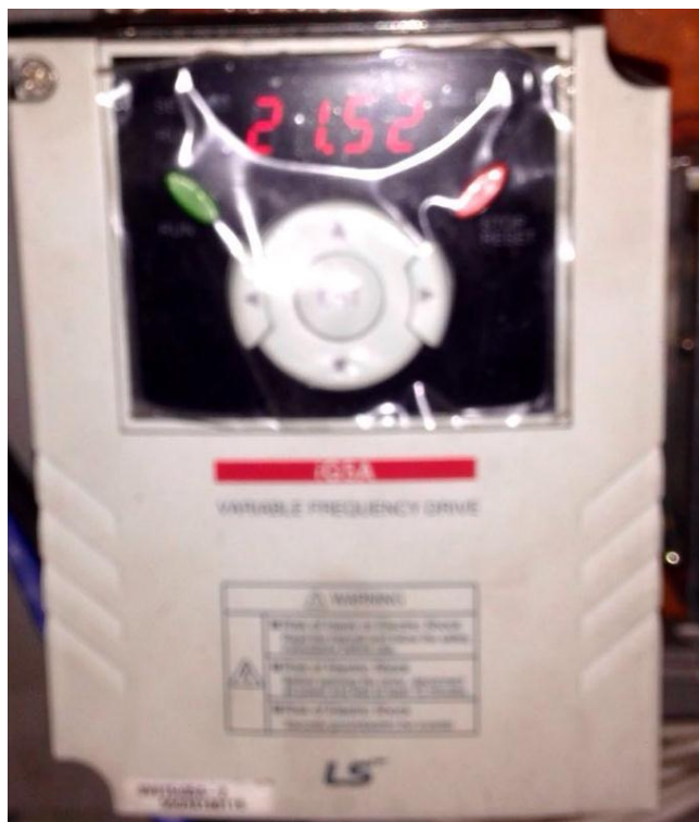
Figura 43 Drive en el gabinete
