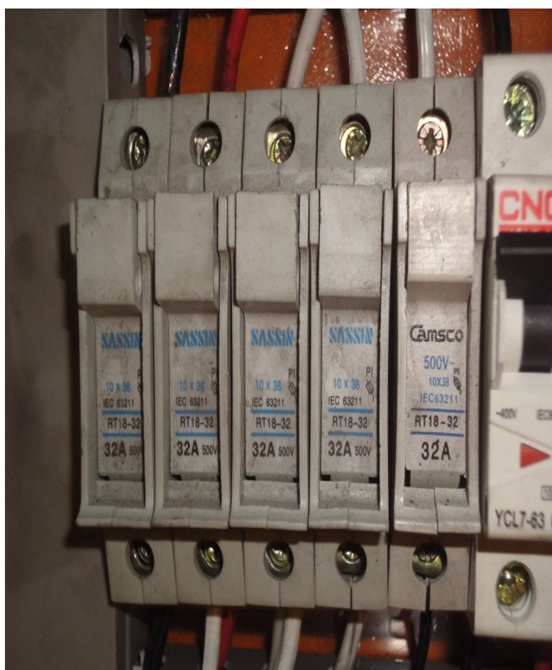
Figura 40 Fusibles en el gabinete
