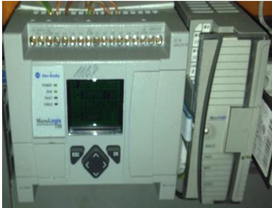
Figura 42 Micrologix en el Gabinete
