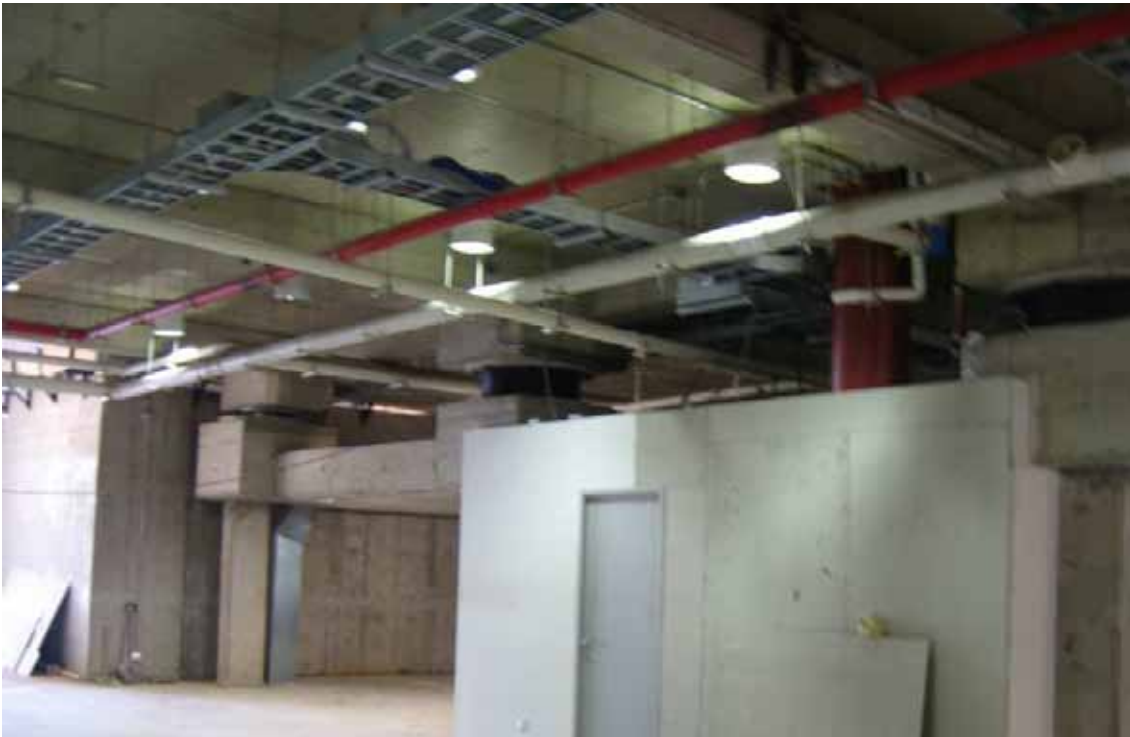
Edificio con aisladores elastoméricos, sobre las columnas de la planta baja, en un edificio de Viña del Mar que se comportó muy bien en el Mega Sismo de Chile de 2010.
