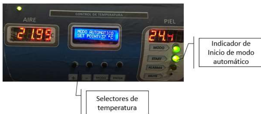
Figura 88 Inicio del proceso de calefacción en el modo automático
