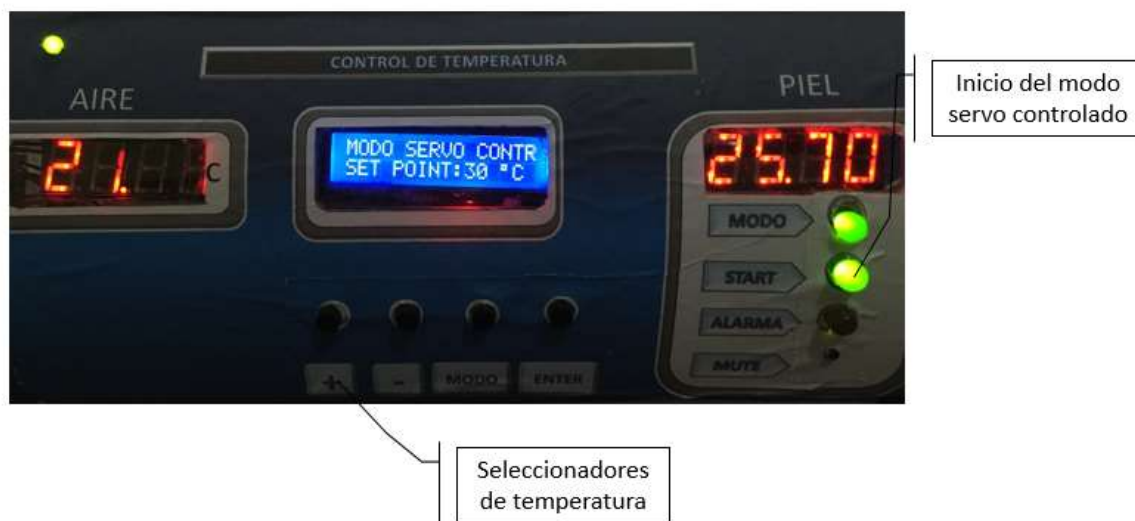
Figura 86 Inicio del proceso de calefacción en el modo servo controlado
