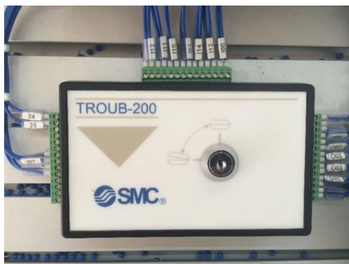
Figura 10. Generador de fallas propia de la estación de Paletizado
