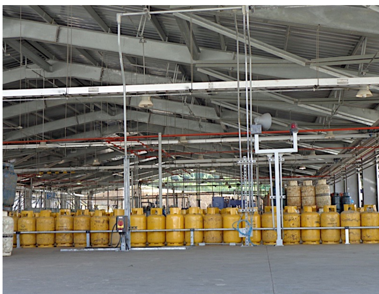
Figura 8. Envasadora de GLP en Terminal el Chorrillo
