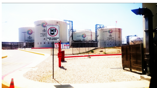
Figura 2. Tanques y Esferas de almacenamiento de GLP
