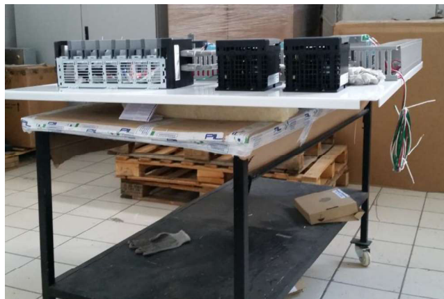
Figura 109. Panel doble fondo listo para ser sujetado en gabinete metálico.
