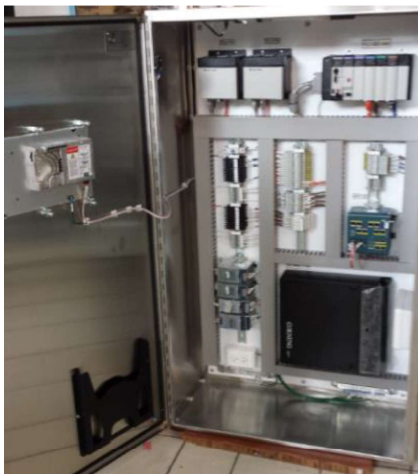
Figura 128. Vista interior del tablero de control ensamblado.
