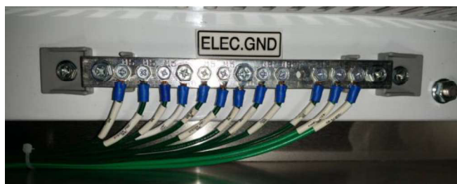
Figura 106. Barra de tierra eléctrica con sus respectivos cables de conexión.
