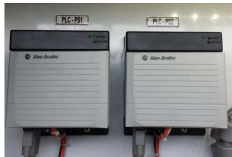
Figura 131. Verificación del funcionamiento operacional de fuentes Allen Bradley.
