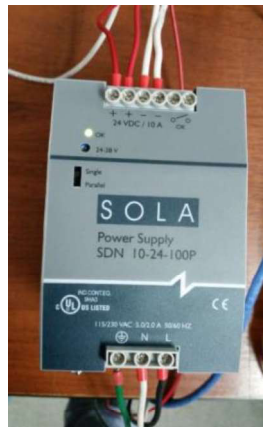
Figura 124. Pruebas de energización de fuentes SOLA.
