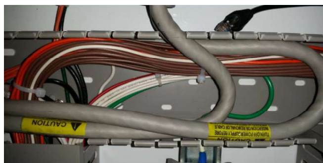
Figura 102. Distribución de cables en canaletas (peinado del cable) (2).
