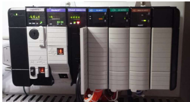
Figura 129. Verificación del funcionamiento operacional del PLC.
