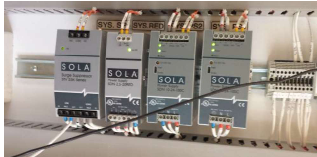
Figura 130. Verificación del funcionamiento operacional de fuentes SOLA.
