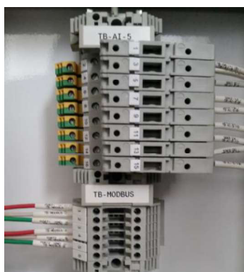
Figura 104. Conexionado del bloque de borneras para entradas analógicas y equipos de comunicación Modbus.
