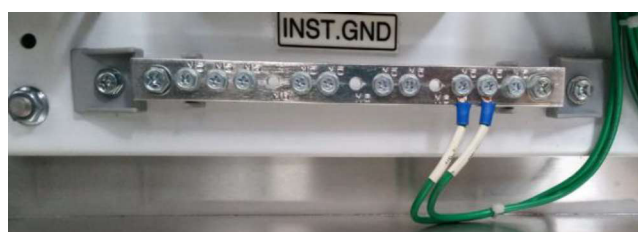
Figura 107. Barra de tierra de instrumentación con sus respectivos cables de conexión.
