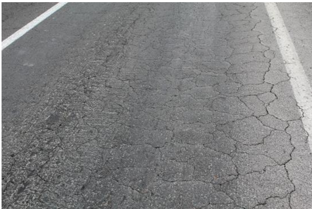
Figura 20. Condición del Pavimento tramo Yambo - Ambato
