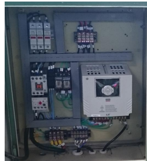
Distribución tablero de control desbobinadora
