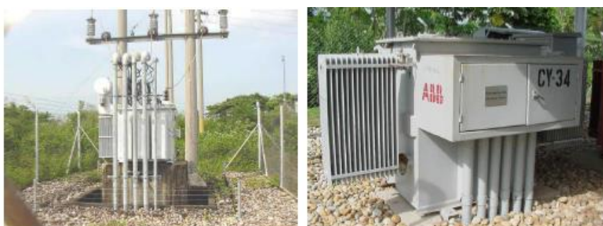
Figura 2. Transformadores (Izquierda SDT, Derecha SUT).
