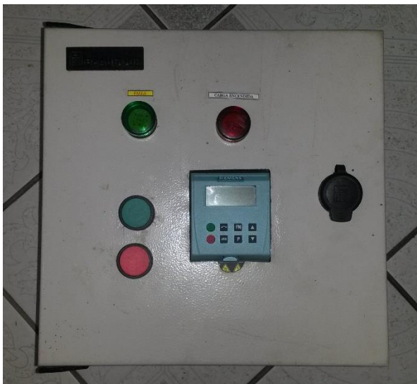
Figura 65: Tablero de control
