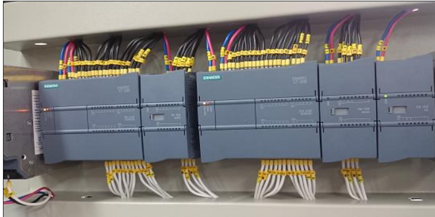
Cableado de Dispositivos.
