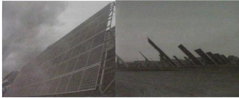
Figura 11 Instalaciones solares sobre el suelo
