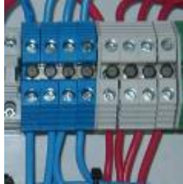
Figura 35 Bornera de conexión
