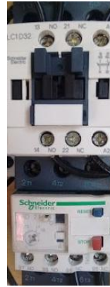
Figura 60 Contactor y guarda motor
