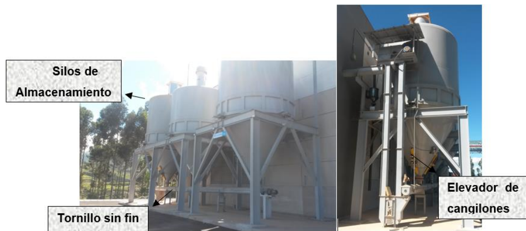
Figura 13 Silos de Almacenamiento.
