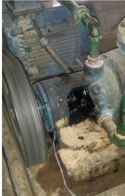
Figura 109 Bomba de mástico con contaminación acumulada
