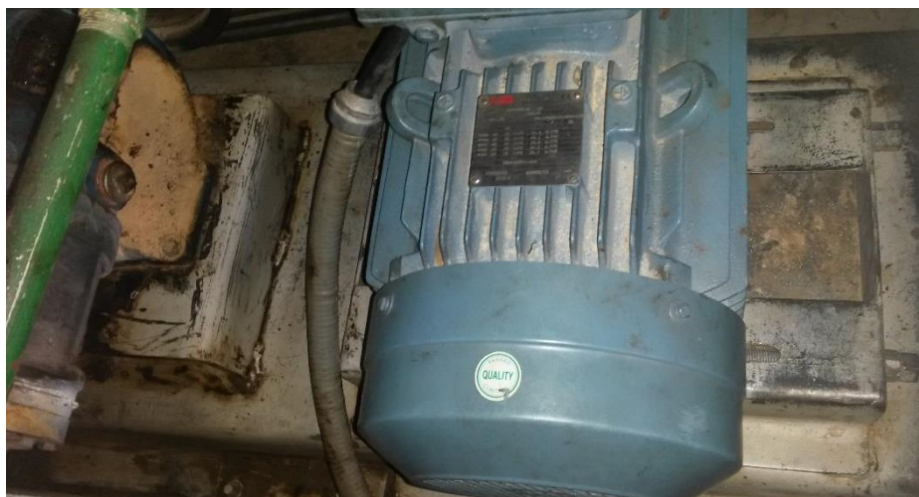
Figura 97 Actividad de Mantenimiento Autónomo. Limpieza de motor-reductores
