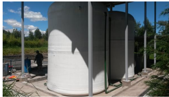
Figura 3 Tanques de planta de tratamiento de aguas residuales
