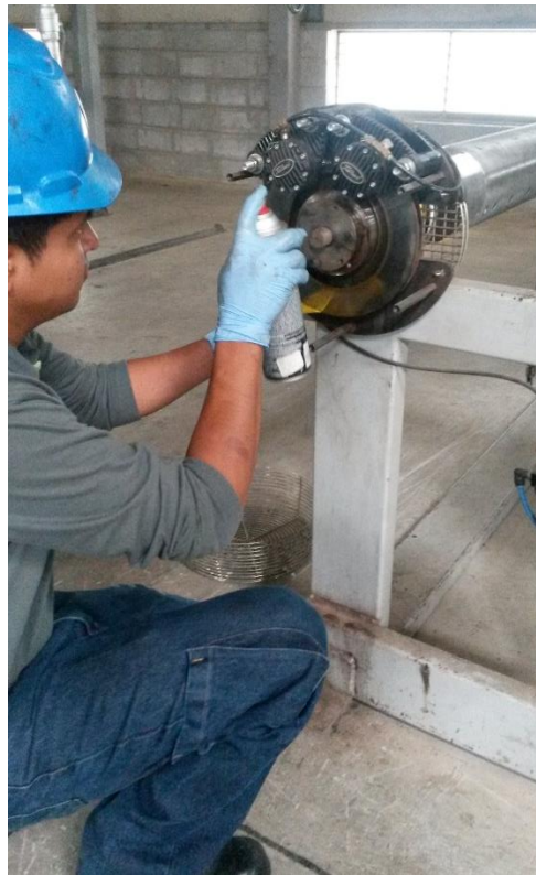
Figura 104 Limpieza de frenos en Controlador de Tensiones
