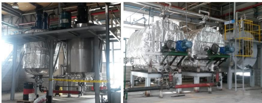
Figura 14 Tanques de pre-mezclado y mezclado
