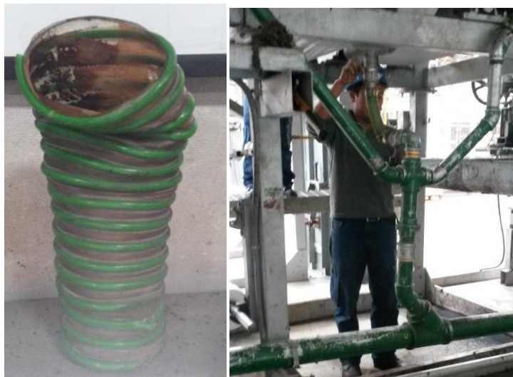
Figura 101 Manguera en malas condiciones, encontrada durante las actividades de Mantenimiento autónomo.
